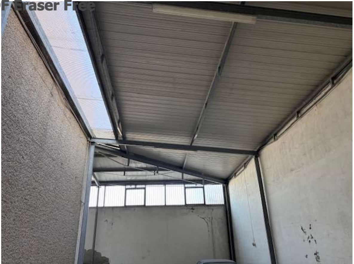
Foto n. 37 – Zona laterale e retrostante il capannone principale, particolare della struttura di copertura
