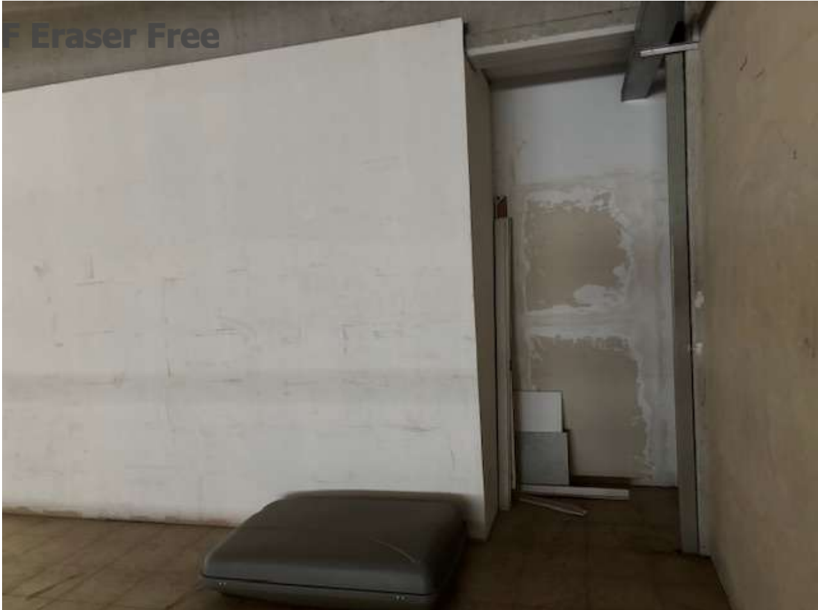
Foto n. 11 – Porta di accesso (murata con cartongesso) di accesso dall'area soprastante gli uffici alla zona archivio
