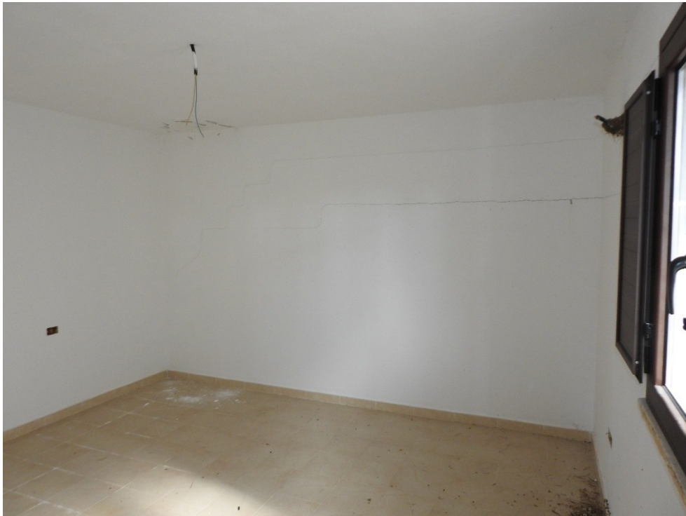
Figura 29 - Piano seminterrato, cantina. Si notino le infiltrazioni dalla parete controterra e le fessurazioni.
