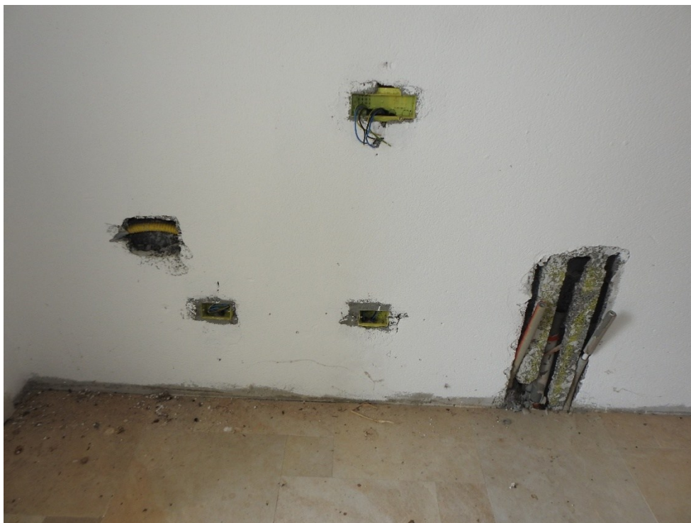
Figura 56 – Impianti non ultimati (cucina)
