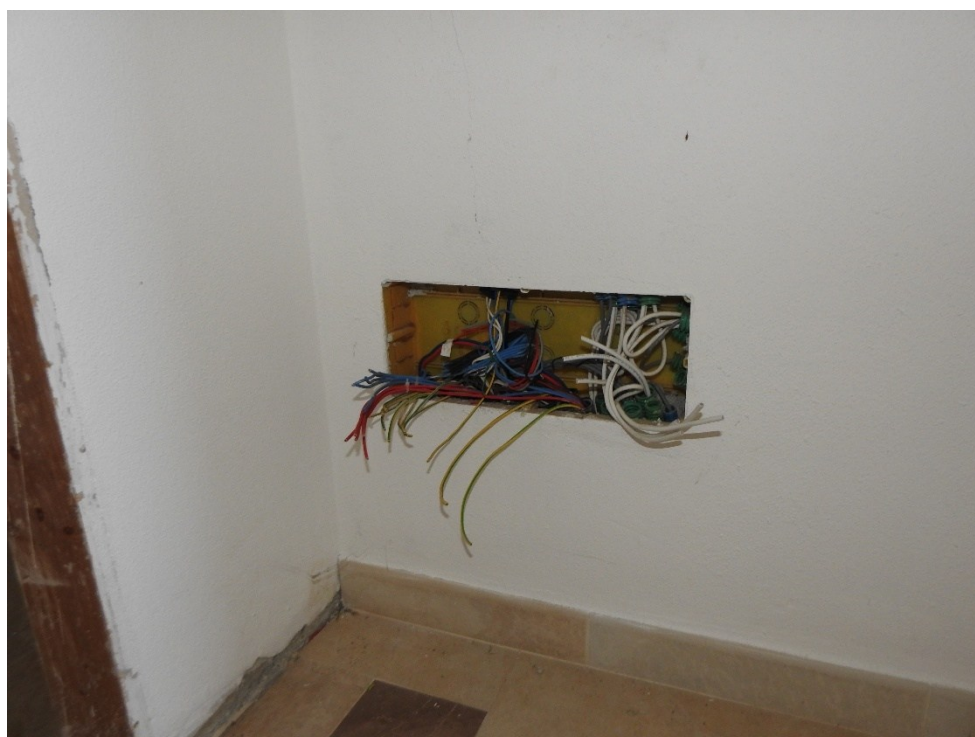
Figura 57 - Scatola di derivazione impianto elettrico, collegamenti mancanti
