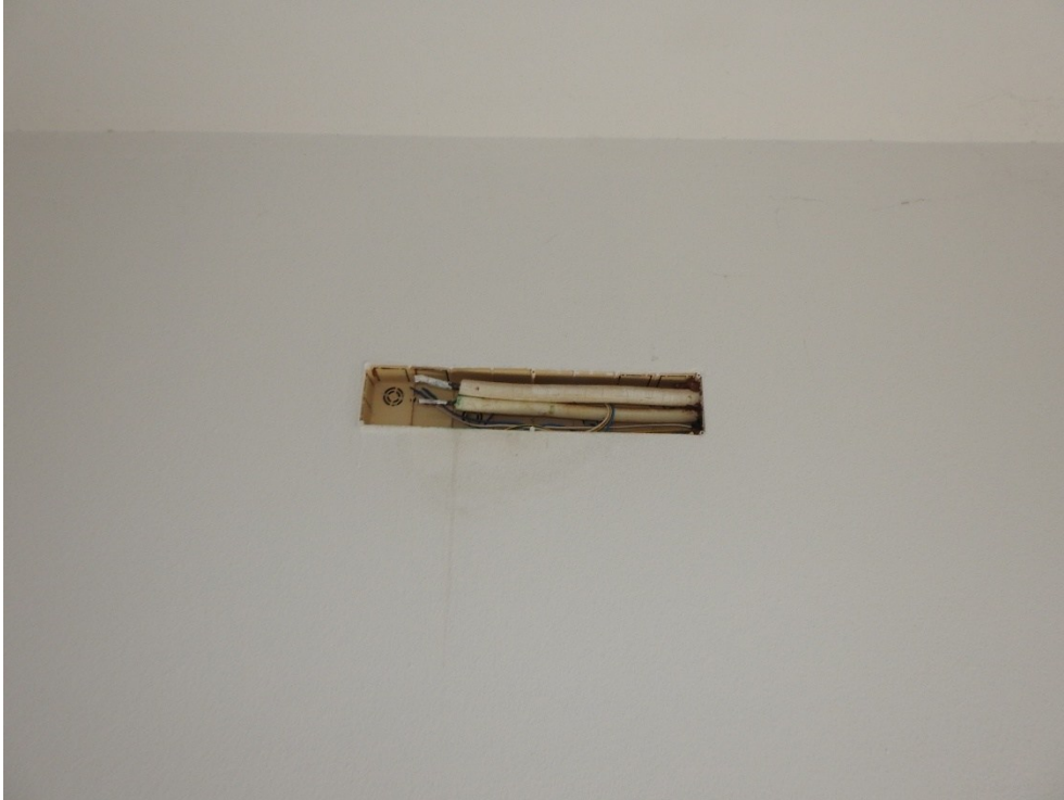
Figura 58 - Impianto di climatizzazione, predisposizione.
