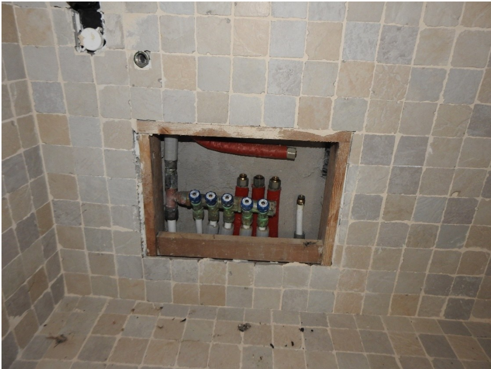
Figura 55 – Collettore impianto idrico piano seminterrato
