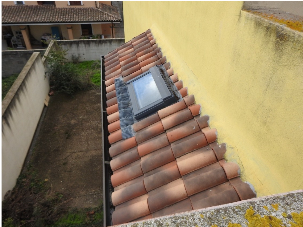
Figura 51 - Visuale del lucernario e della porzione laterale del cortile di proprietà esclusiva del Lotto
