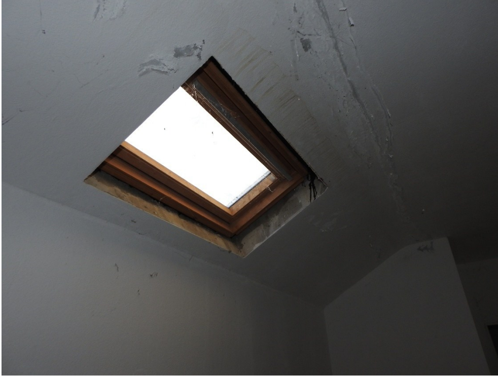
Figura 54 - Patologie edilizie, importanti infiltrazioni nella zona del lucernario (piano terra)
