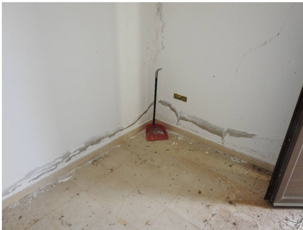
Figura 52 - Patologie edilizie, umidità per capillarità al piano seminterrato
