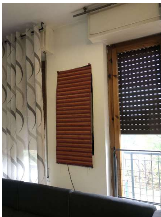
DETTAGLIO CALDAIA COLLOCATA IN NICCHIA LOCALE SOGGIORNO COPERTA DA TENDA
