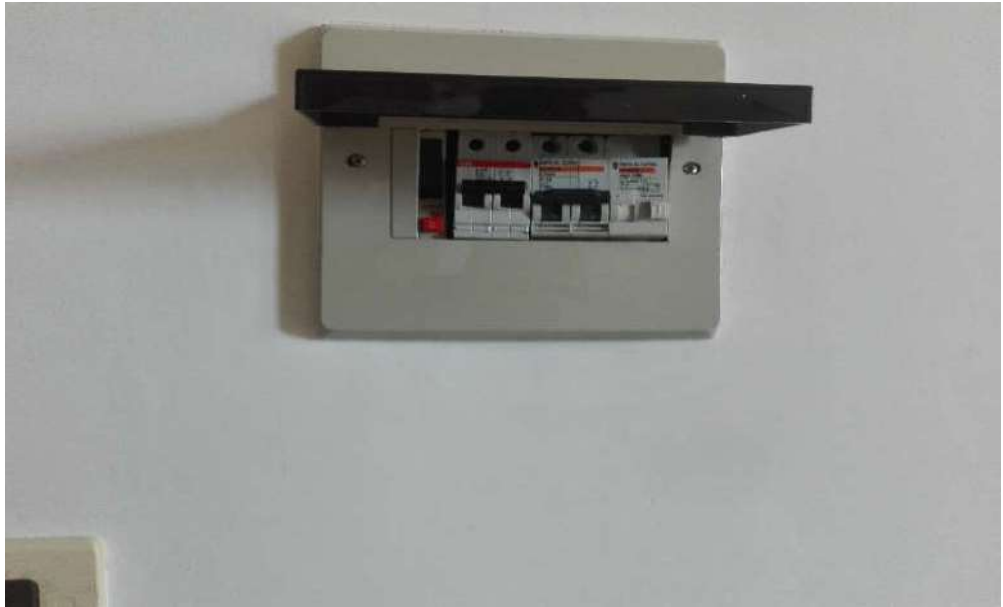
25 | Particolare quadro elettrico
