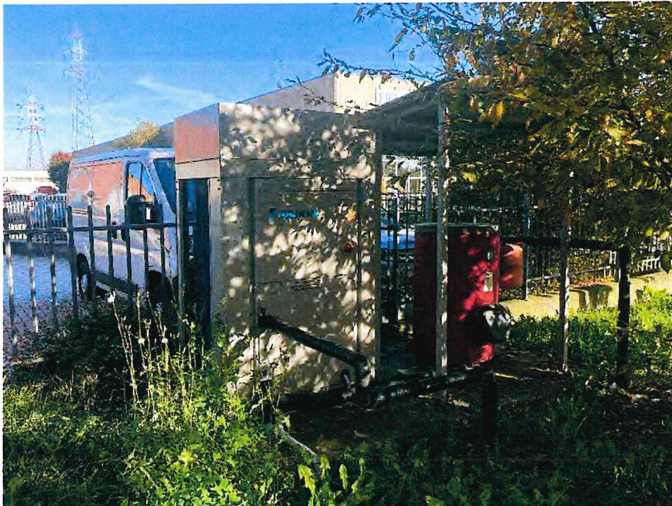
10. Macchinari a servizio del capannone, unità esterne e serbatoio d'accumulo.
