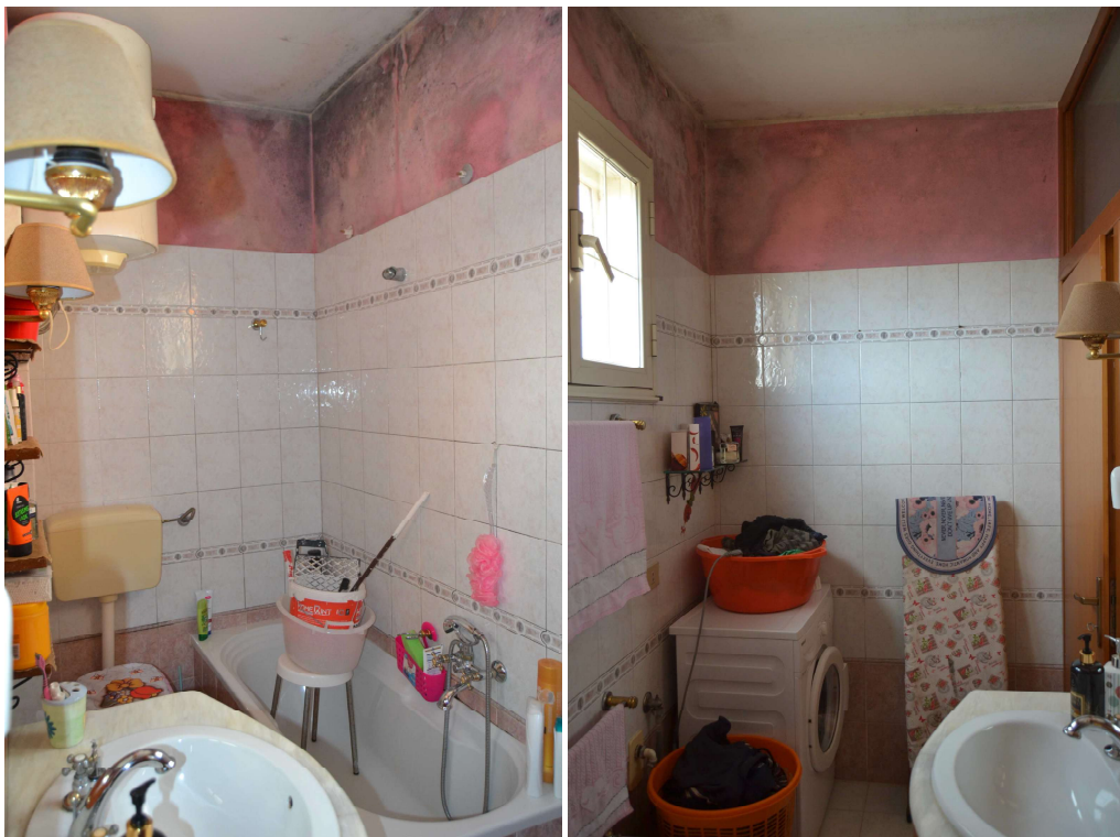
Figura 13 – servizio igienico – in dettaglio evidente tracce di umidità da infiltrazione e da condensa
