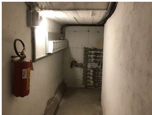
vano contatori condominiale
