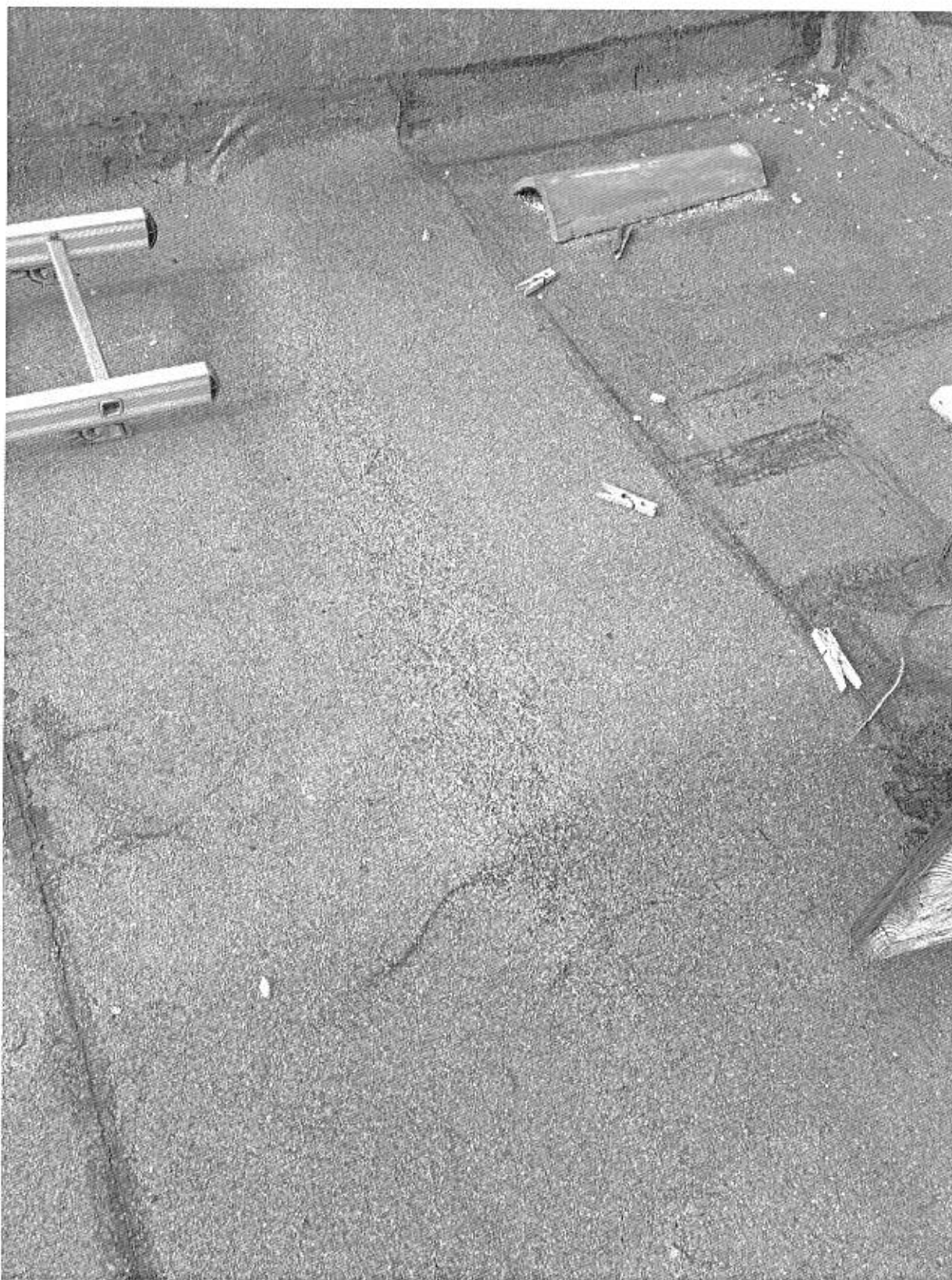
Foto n° 60 - Piano Primo - Terrazza, particolari guaina
