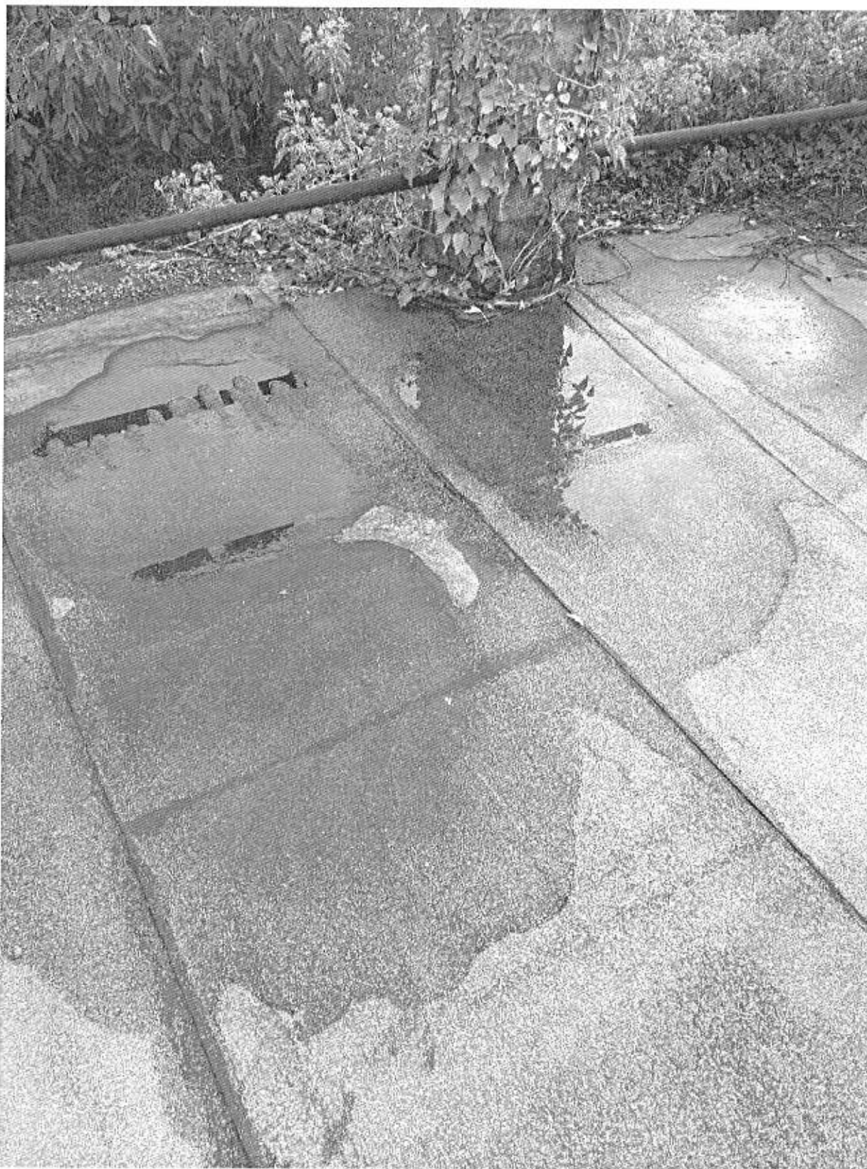
Foto n° 58 - Piano Primo - Terrazza, particolari guaina
