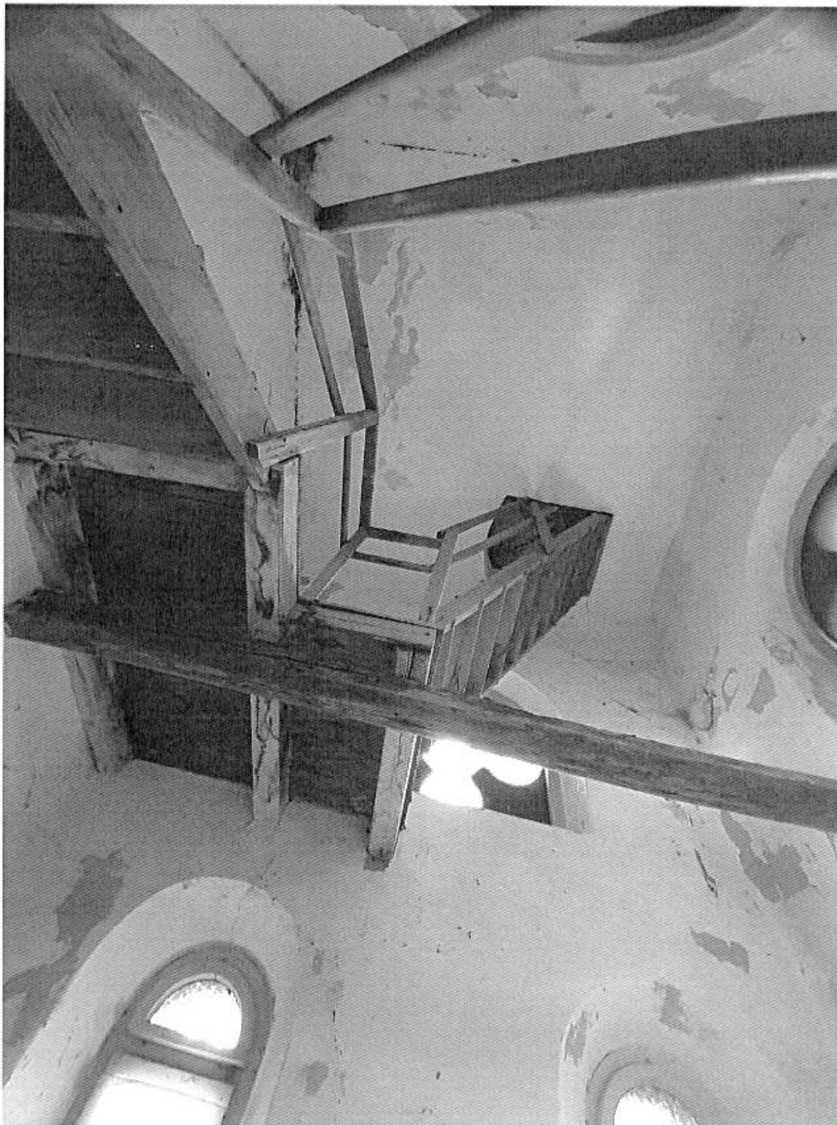
Foto n° 79 - Piano Secondo - sviluppo interno complessivo del Vano Torre (vista sul sovrastante Piano Terzo), scorcio della scaletta di accesso al Piano Quarto (Terrazza Panoramica)
