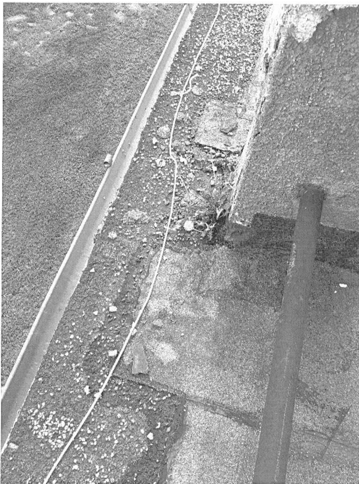
Foto n° 62 - Piano Primo - Terrazza, particolari guaina
