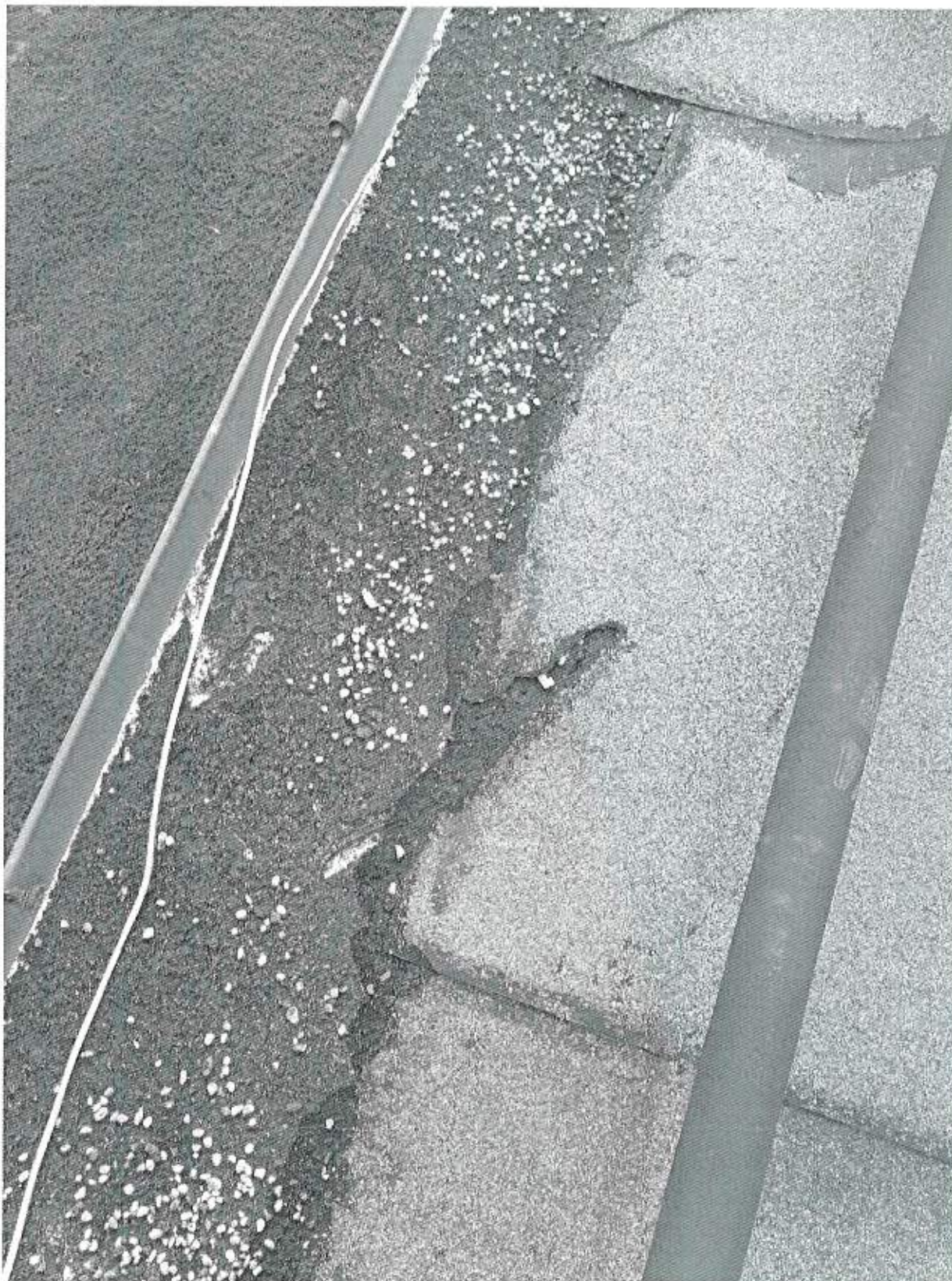
Foto n° 63 - Piano Primo - Terrazza, particolari guaina
