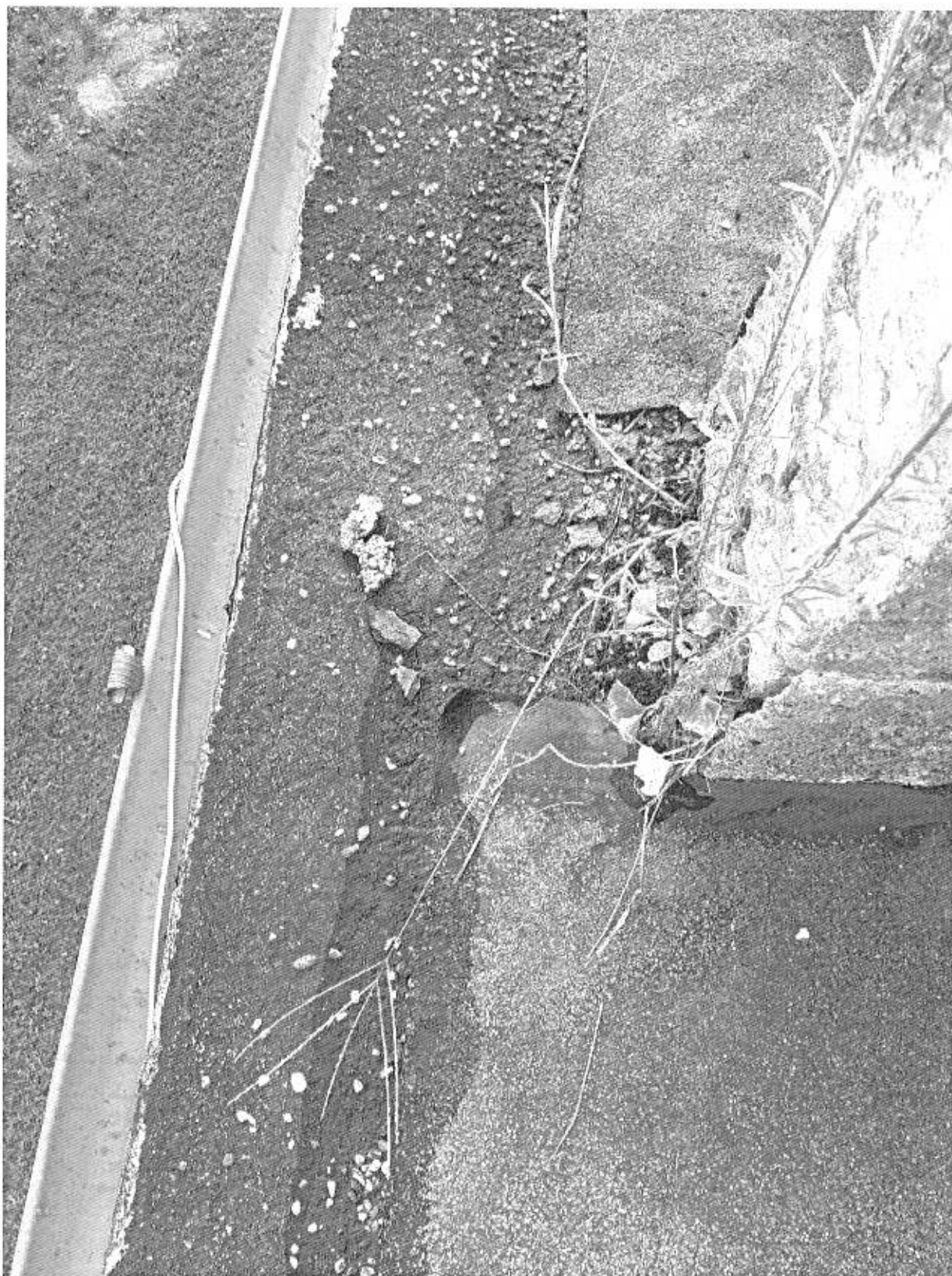
Foto n° 64 - Piano Primo - Terrazza, particolari guaina
