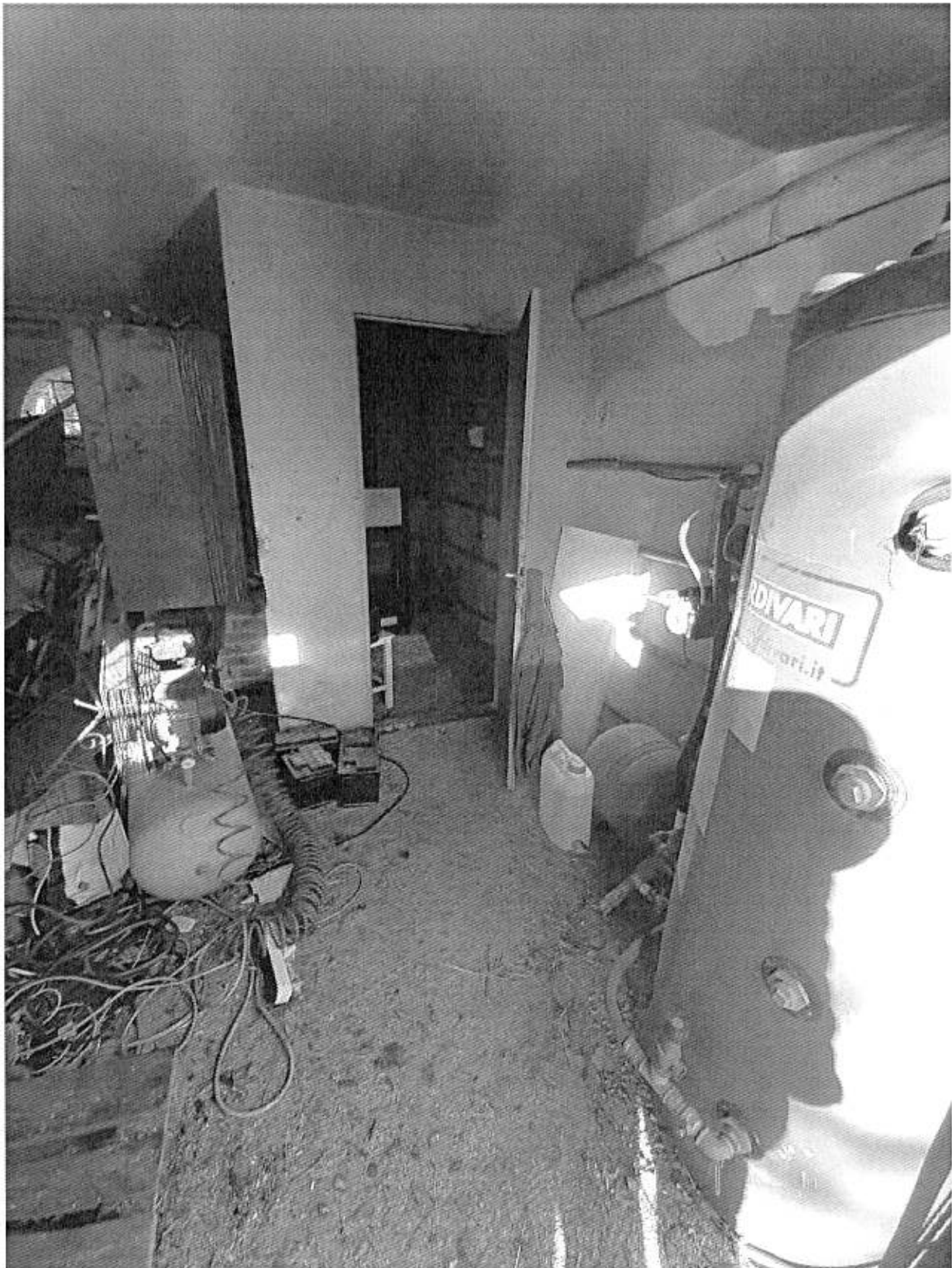
Foto n° 93 - Piano Terra - Centrale Termica (pellet) e Locale di Sgombero
