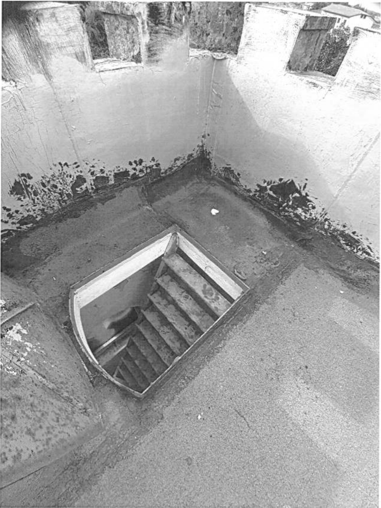
Foto n° 84 - Piano Quarto - Botola e Scaletta di accesso alla Terrazza Panoramica del Piano
