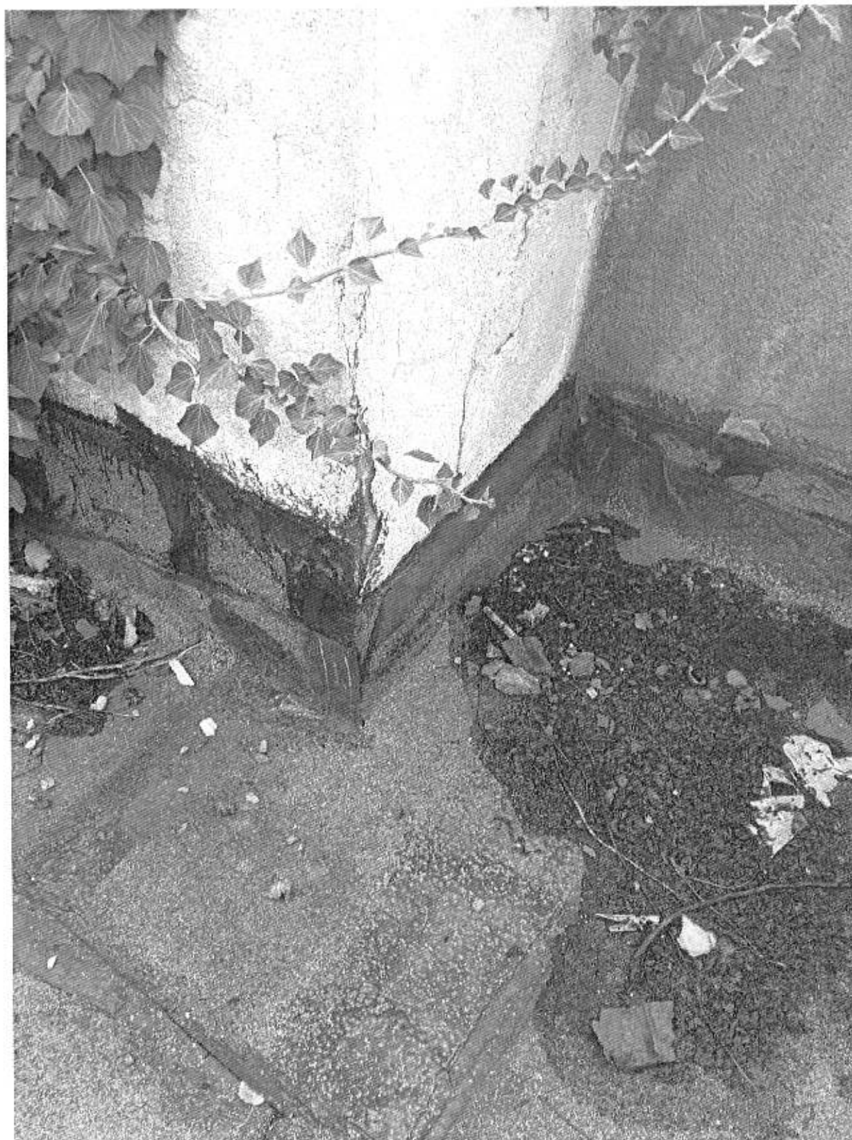
Foto n° 57 - Piano Primo - Terrazza, particolari guaina
