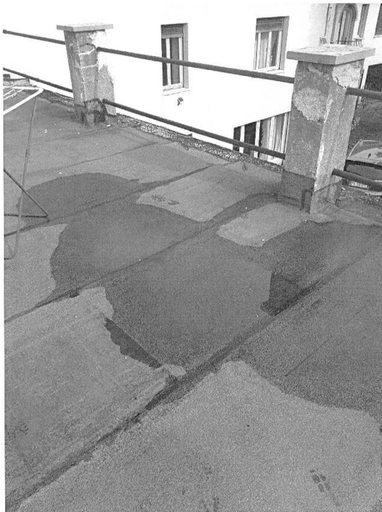
Foto n° 59 - Piano Primo - Terrazza, particolari guaina
