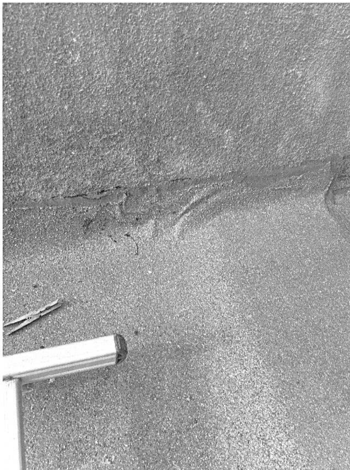
Foto n° 61 - Piano Primo - Terrazza, particolari guaina
