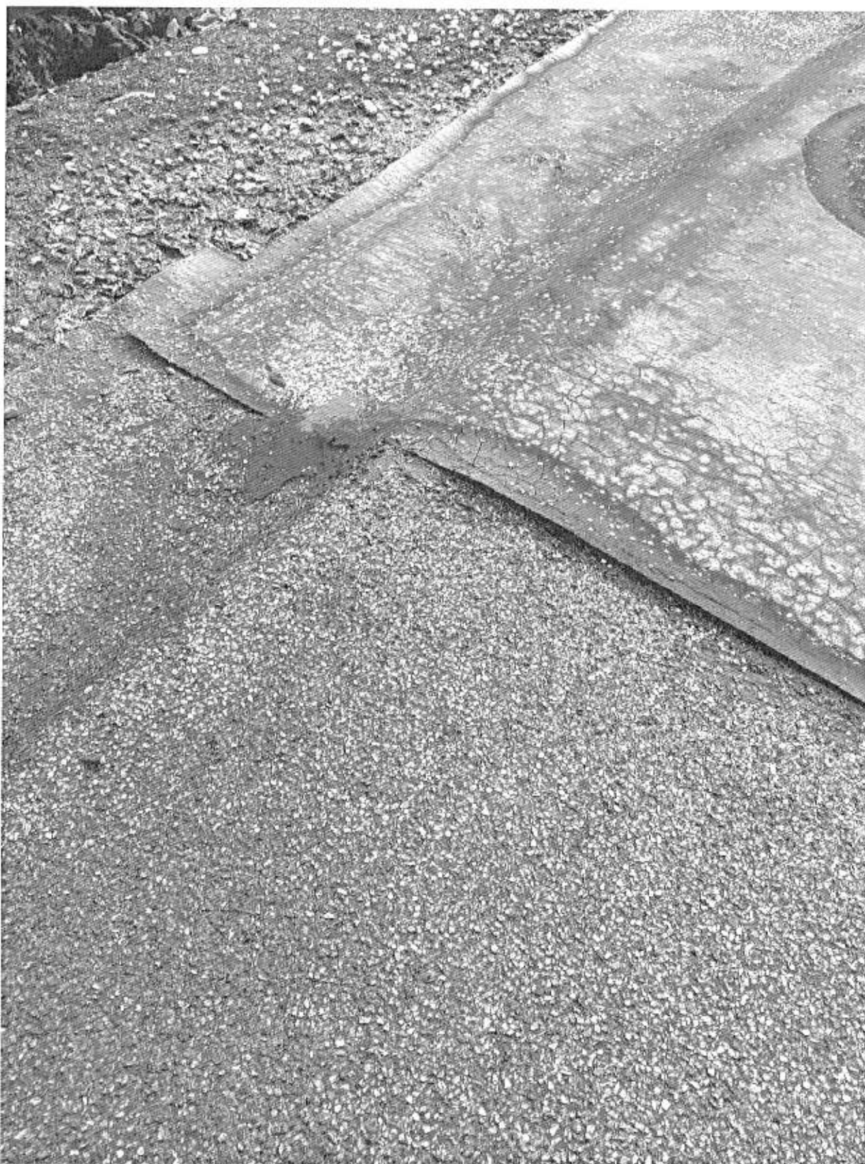
Foto n° 66 - Piano Primo - Terrazza, particolari guaina
