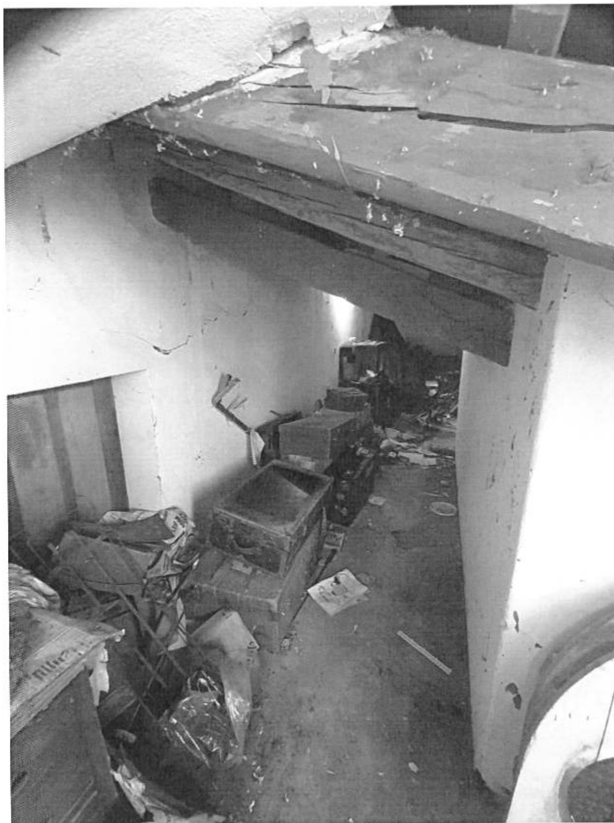
Foto n° 71 - Piano Secondo - Sottotetto visto dal Vano Torre, a sinistra il Cavedio di Accesso al Sottotetto 2
