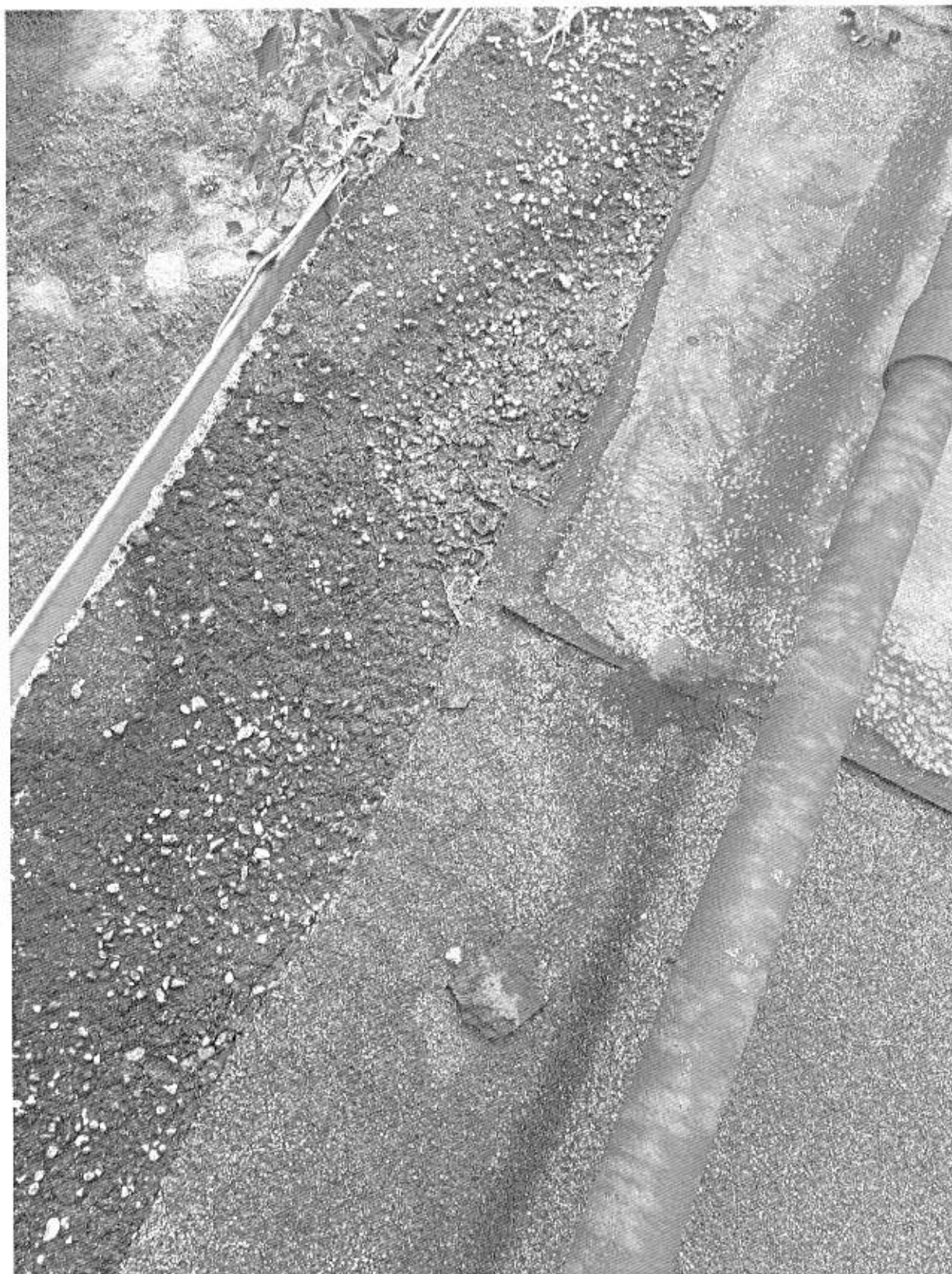
Foto n° 65 - Piano Primo - Terrazza, particolari guaina
