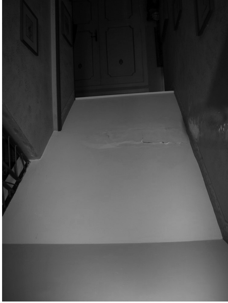
Foto n° 23 – Appartamento in Gela nel vicolo Giardinelli n° 28, foglio 253, part. 339 sub 11, graffate part. 340 sub 9 e part. 341 sub 10 – Panoramica degli interni del 2° piano (scala di accesso al 3° piano, ammaloramento solaio).
