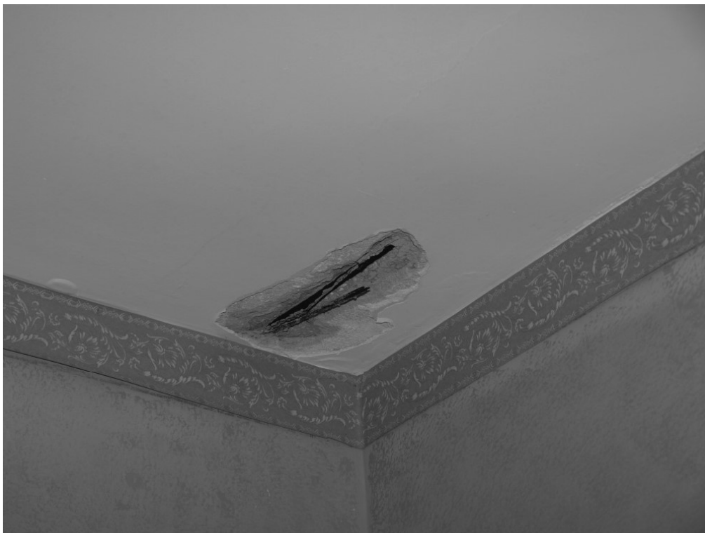
Foto n° 10 – Appartamento in Gela nel vicolo Giardinelli n° 28, foglio 253, part. 339 sub 11, graffate part. 340 sub 9 e part. 341 sub 10 – Panoramica degli interni del 2° piano (ammaloramento del solaio).
