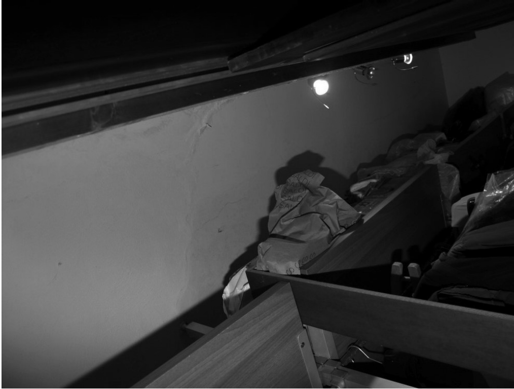
Foto n° 19 – Appartamento in Gela nel vicolo Giardinelli n° 28, foglio 253, part. 339 sub 11, graffate part. 340 sub 9 e part. 341 sub 10 – Panoramica degli interni del 2° piano (ammaloramento solaio).
