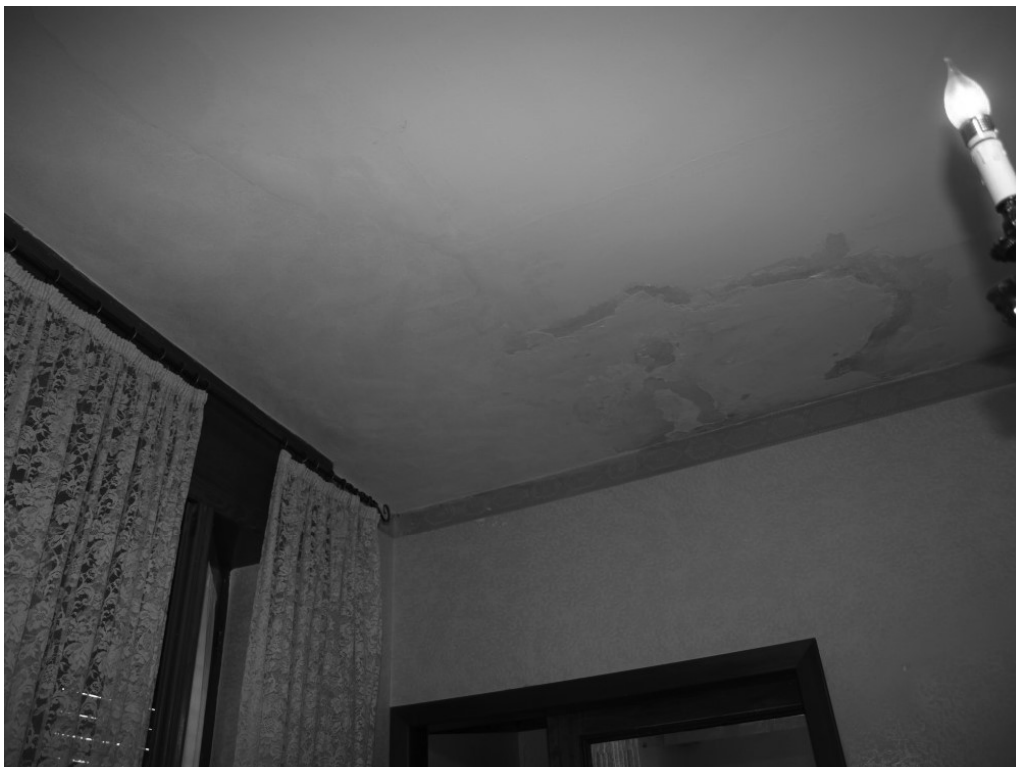
Foto n° 18 – Appartamento in Gela nel vicolo Giardinelli n° 28, foglio 253, part. 339 sub 11, graffate part. 340 sub 9 e part. 341 sub 10 – Panoramica degli interni del 2° piano (ammaloramento del solaio).
