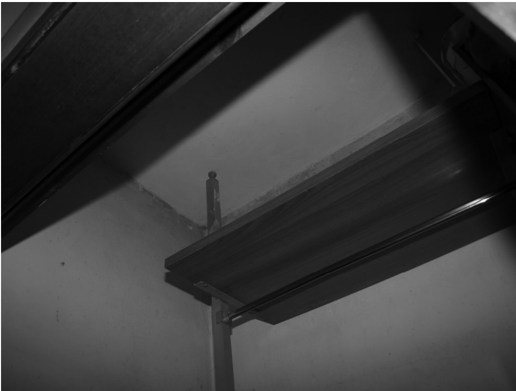
Foto n° 20 – Appartamento in Gela nel vicolo Giardinelli n° 28, foglio 253, part. 339 sub 11, graffate part. 340 sub 9 e part. 341 sub 10 – Panoramica degli interni del 2° piano (ammaloramento del solaio).
