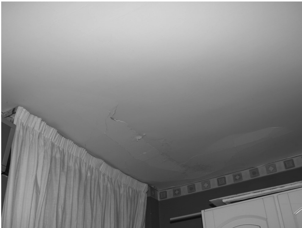
Foto n° 14 – Appartamento in Gela nel vicolo Giardinelli n° 28, foglio 253, part. 339 sub 11, graffate part. 340 sub 9 e part. 341 sub 10 – Panoramica degli interni del 2° piano (ammaloramento del solaio).
