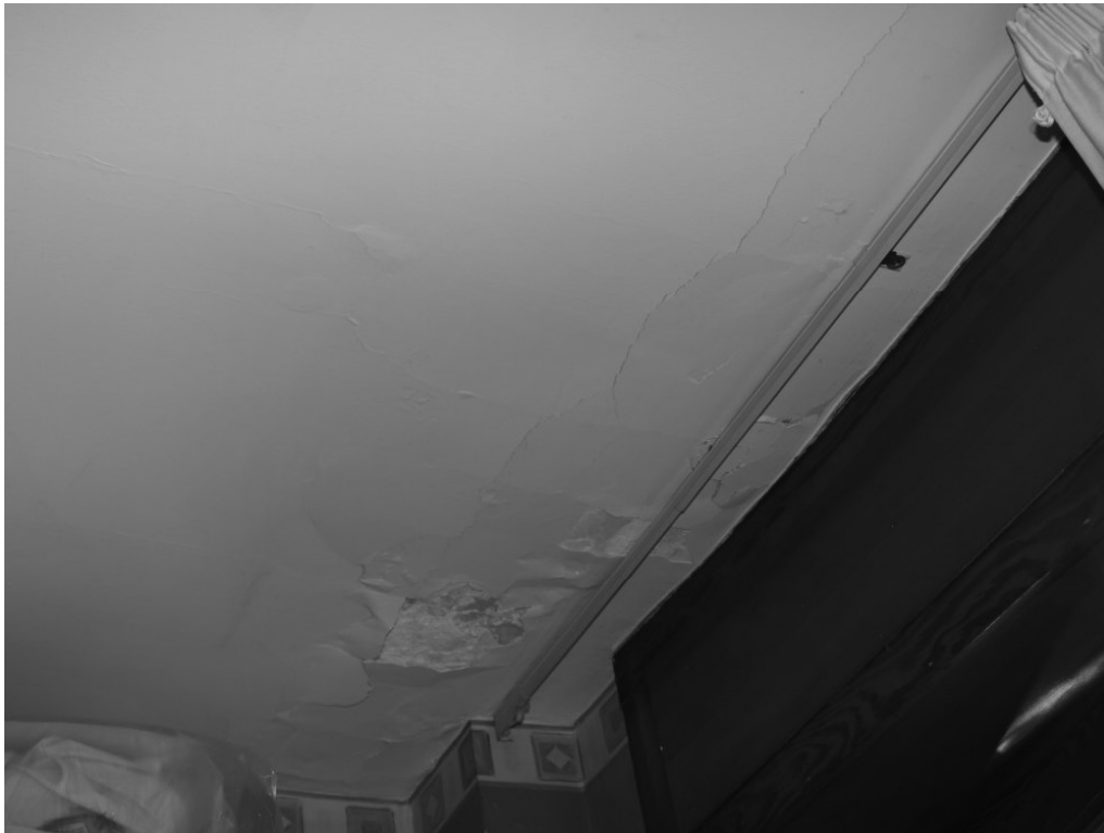
Foto n° 15 – Appartamento in Gela nel vicolo Giardinelli n° 28, foglio 253, part. 339 sub 11, graffate part. 340 sub 9 e part. 341 sub 10 – Panoramica degli interni del 2° piano (ammaloramento del solaio).
