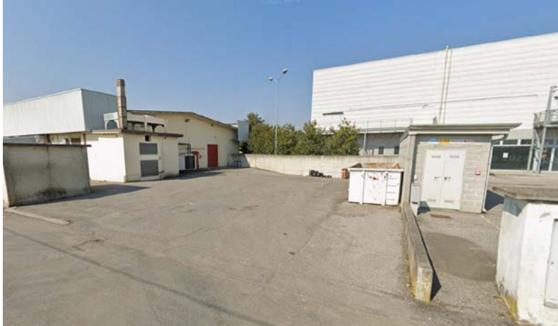
Cabina E- Distribuzione
