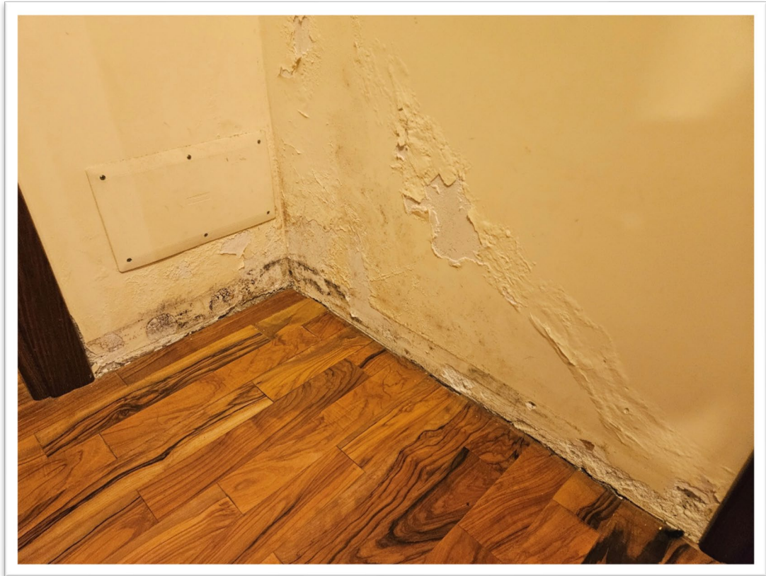
Foto 27 – Particolare umidità da presunta perdita impianto idrico bagno comune piano primo
