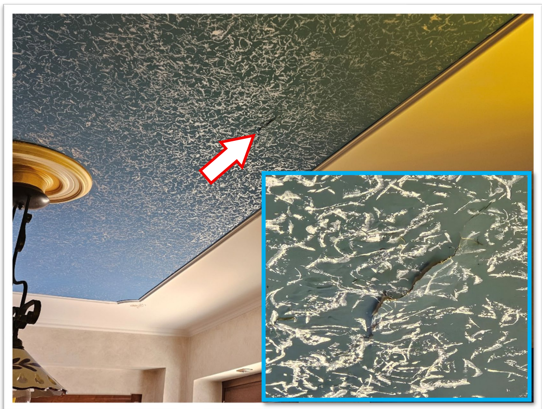
Foto 28 – Particolare distacco intonaco soffitto salotto in corrispondenza della presunta perdita impianto idrico bagno comune piano primo
