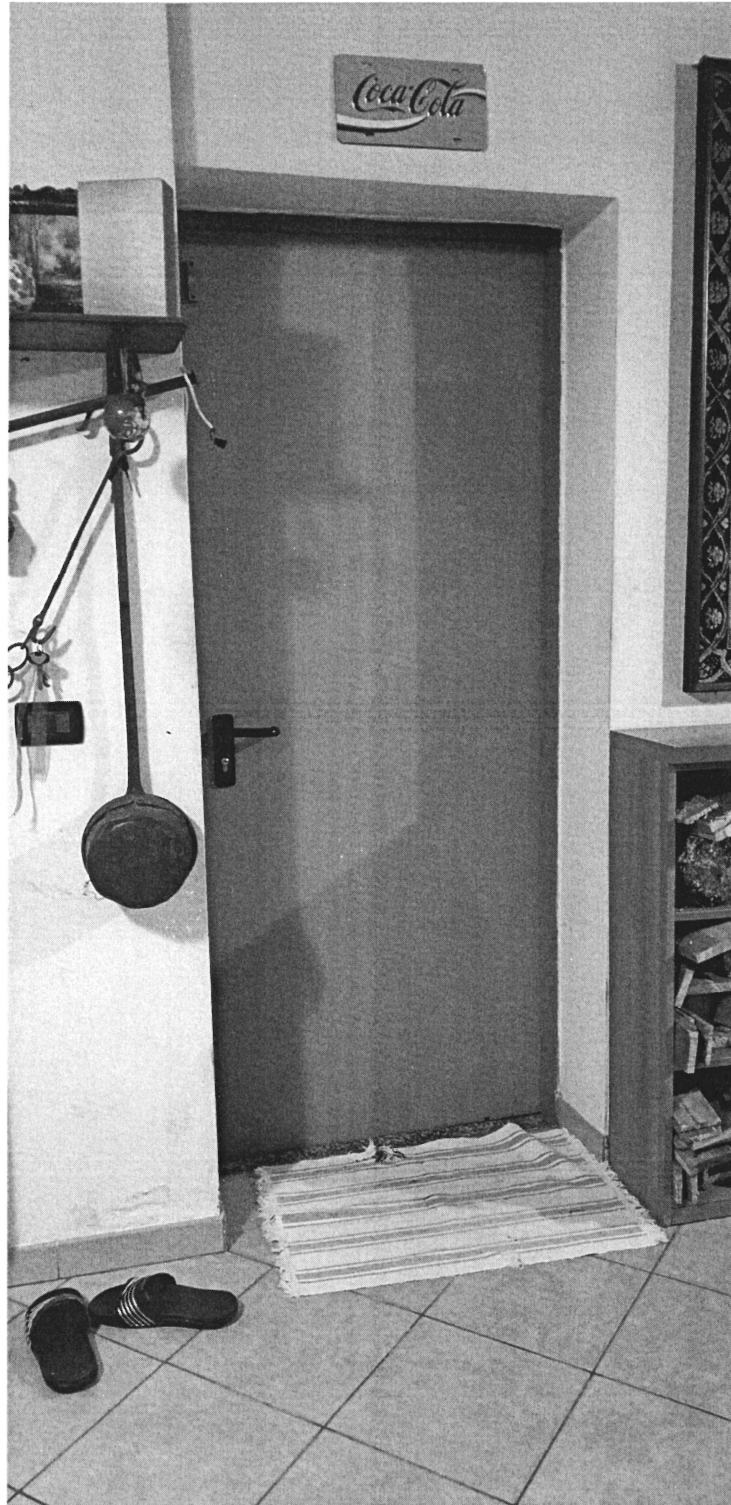
Porta REI di accesso dal locale di sgombero alla rampa di accesso all'autorimessa.
