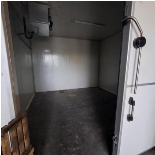
Foto 9 – Cella frigorifera al piano terra
