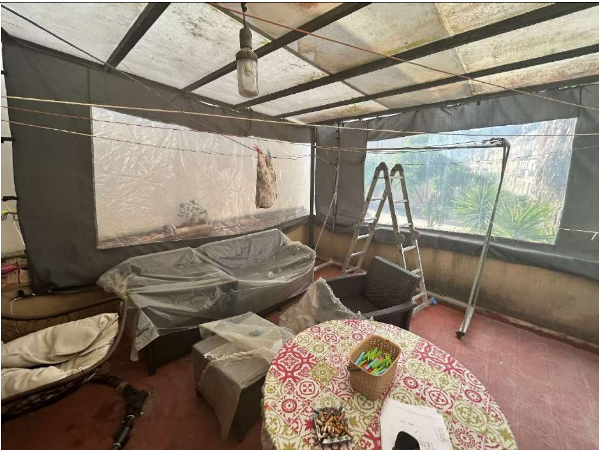
Foto n.18 – Vista del balcone esterno coperto da un telo e struttura “precaria”.
