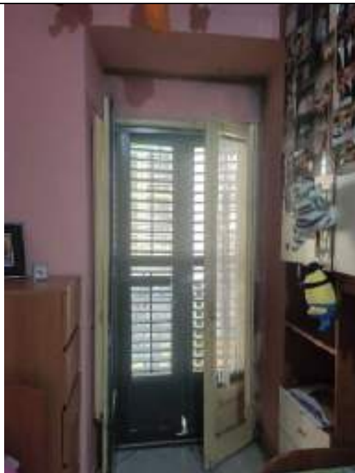
F. Particolare degli infissi in legno e persiane
