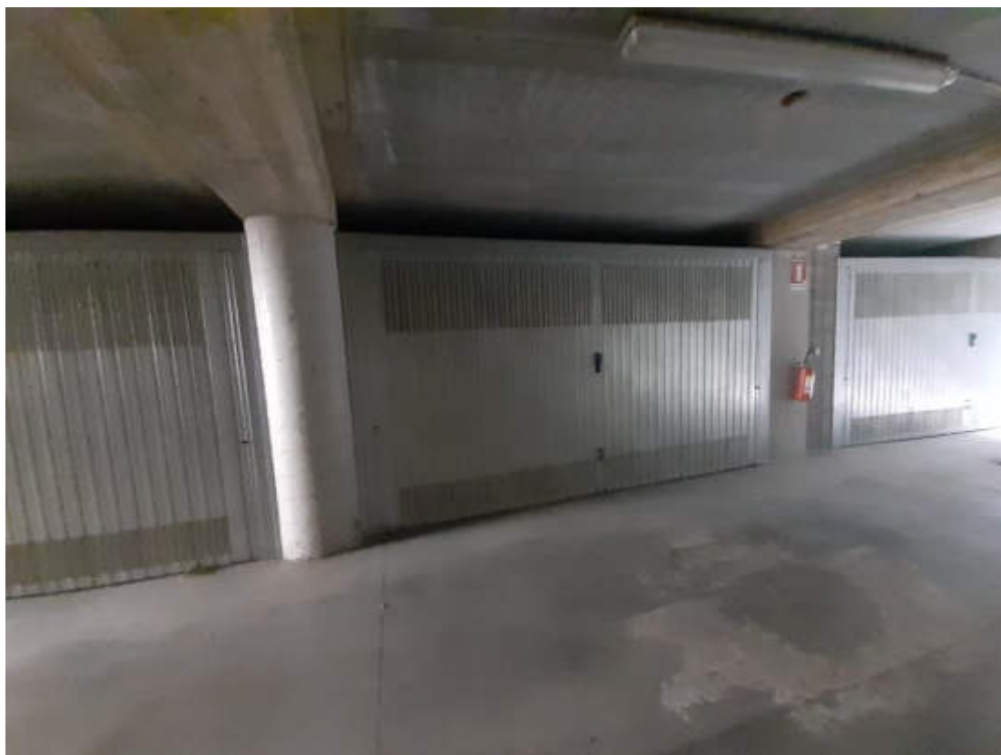
Vista da corsia di accesso comune del portone di accesso alla U.I.U. oggetto di valutazione
