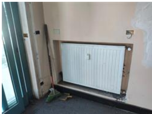
impianto di riscaldamento
