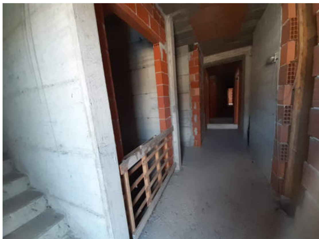
Vista interna della suddivisione degli ambienti del vano scala comune e grado rifiniture
