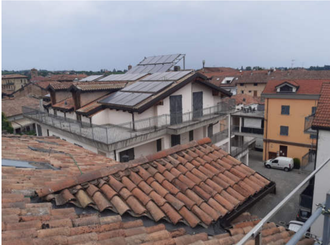
Vista impianto fotovoltaico a servizio del fabbricato condominiale
