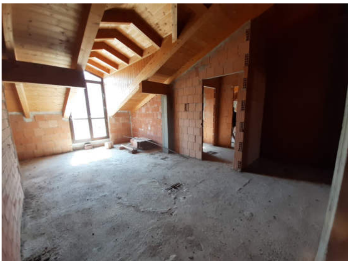
Vista interna della suddivisione degli ambienti e grado rifiniture piano primo, secondo e sottotetto
