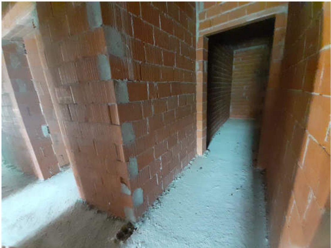
Vista interna della suddivisione degli ambienti del vano scala comune e grado rifiniture
