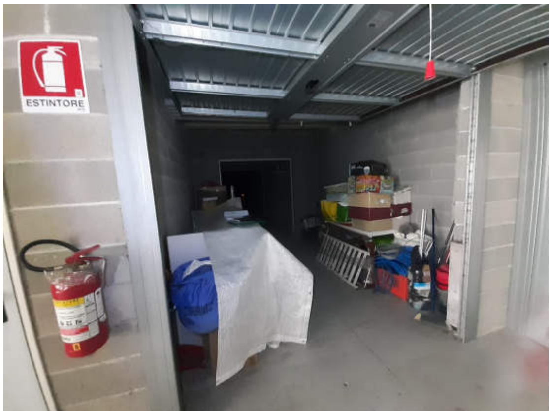
Vista dalla corsia di manovra in piano interrato del portone di accesso alla U.I.U.
