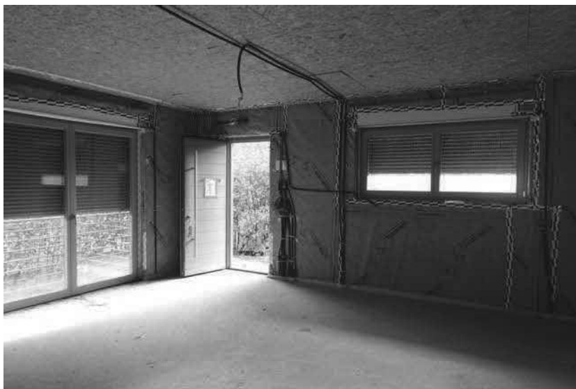
Vista al P.T. unità 5 fabbricato B1
