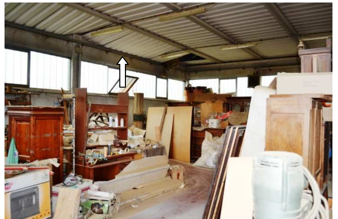
foto 13 - L'angolo ovest con controsoffitto in dissesto
