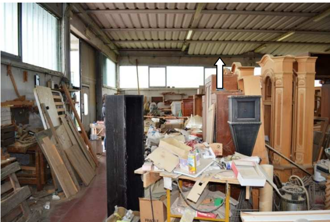
foto 12 - L'angolo sud con controsoffitto in dissesto
