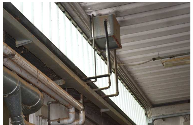
foto 18 - Vista della vasca d'espansione imp. idrico
