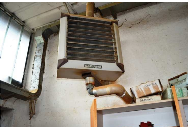
foto 17 - Particolare di uno degli aerotermini a soffitto
