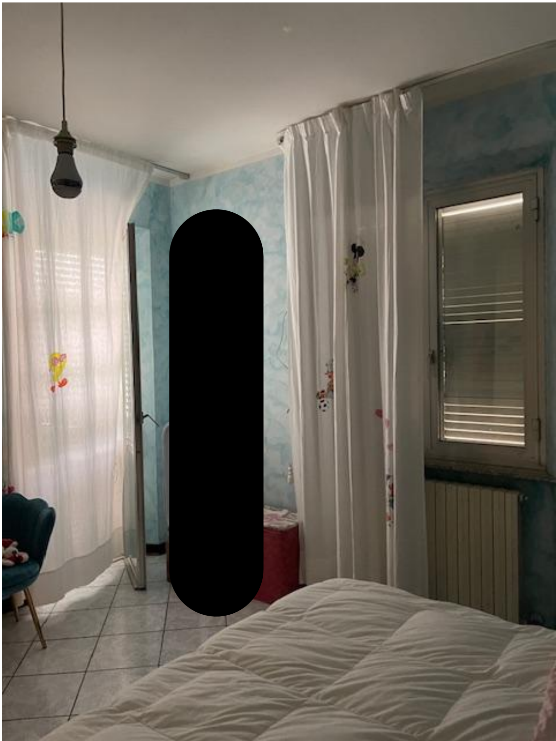
vista della finestra a parapetto della camera ovest non conforme in quanto non presente nella planimetria del precedente edilizio agli atti
