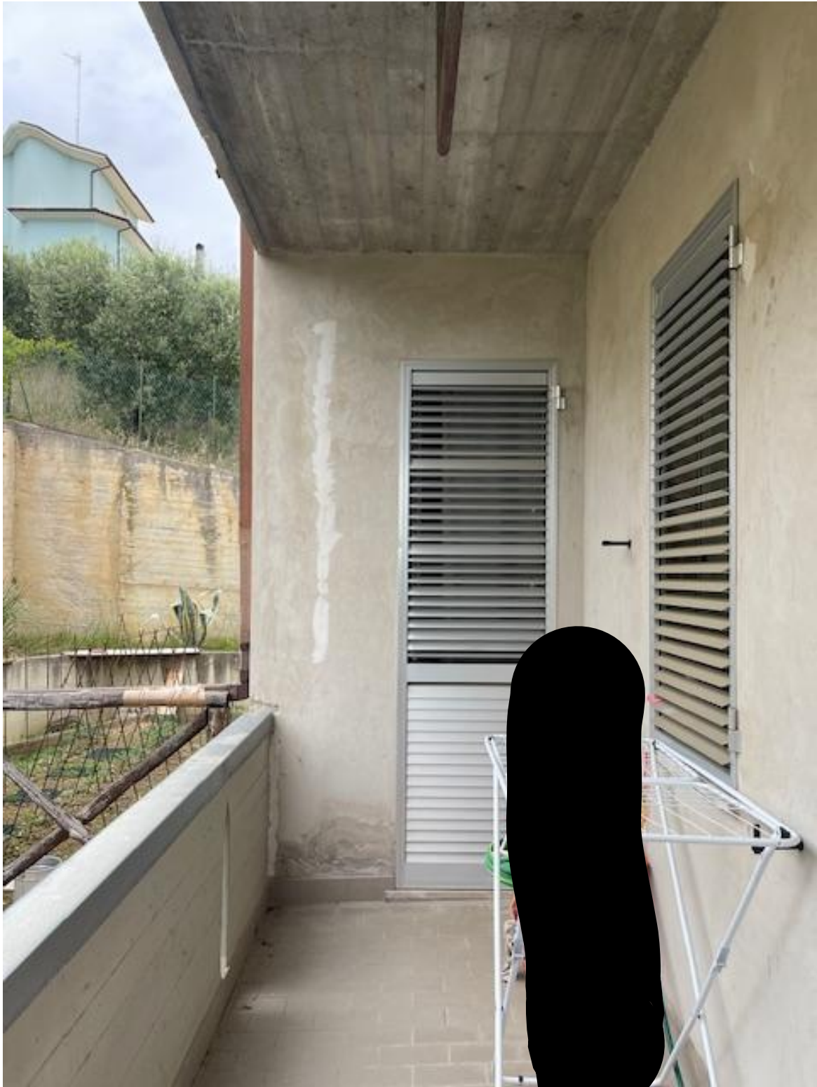
balcone lato ovest, il parapetto non risponde alle norme di sicurezza
