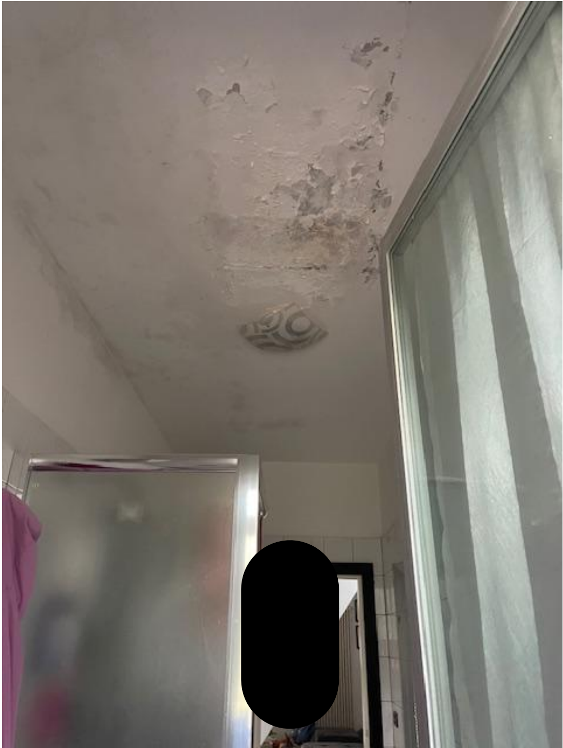
fenomeni di umidità nel bagno zona giorno
