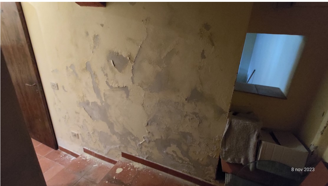
Foto 16 - particolare disimpegno stato conservazione muro
