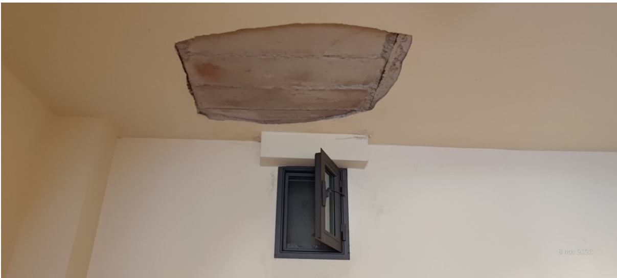
Foto 8 – particolare rovina intonaco solaio
