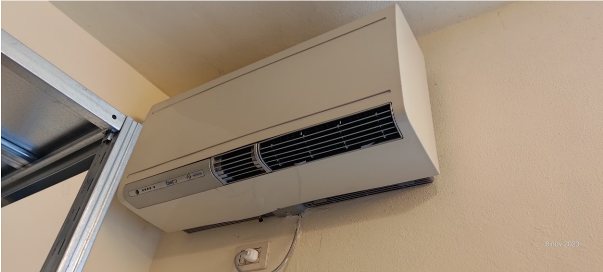
Foto 9 – particolare ventilconvettore a parete
