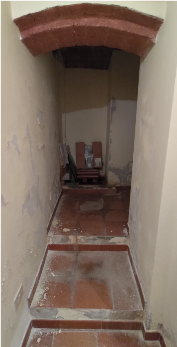
Foto 11 disimpegno particolare umidità di risalita
