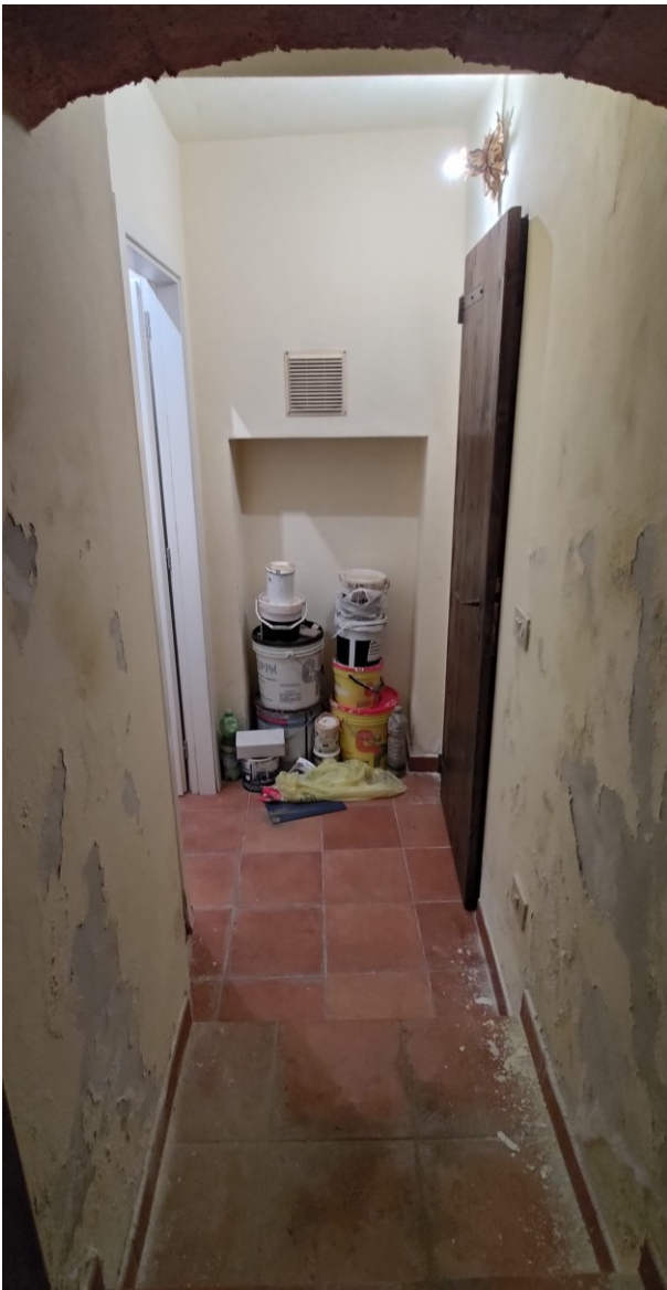
Foto 10 – disimpegno particolare umidità di risalita
