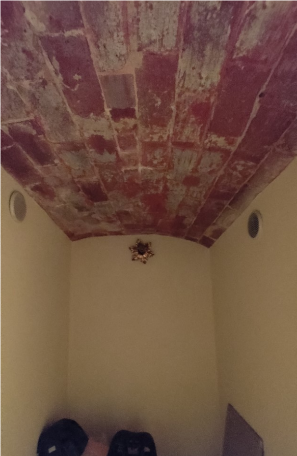
Foto 15 – ripostiglio particolare soffitto
