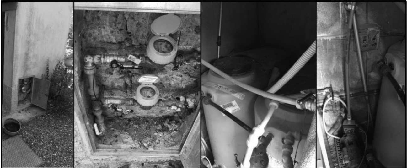
Punto di fornitura acqua con contatore e depositi in vano tecnico
