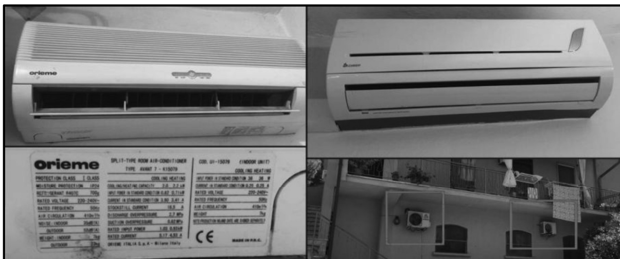
Due pompe di calore mono e split al piano terra
