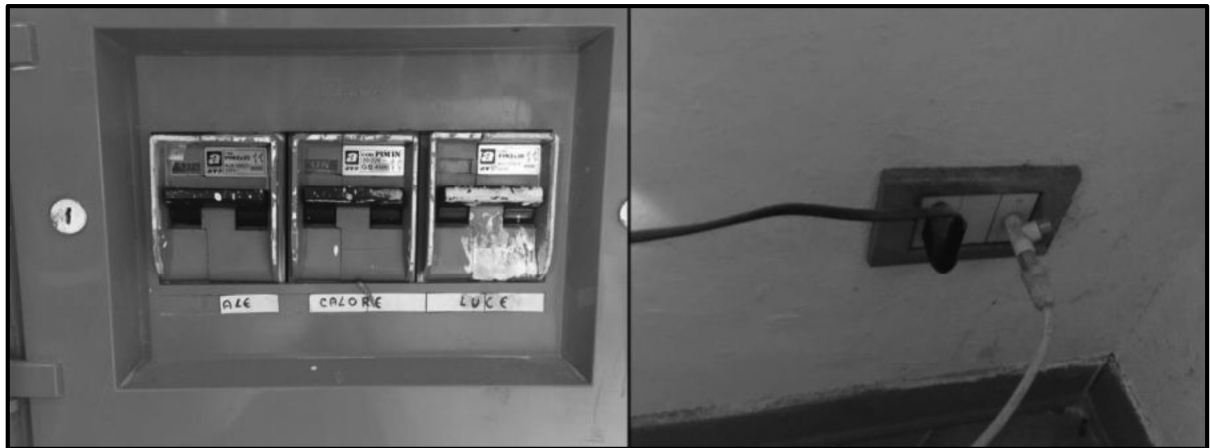
Impianto elettrico: quadri elettrici e dettaglio impianto nel sub. 2
