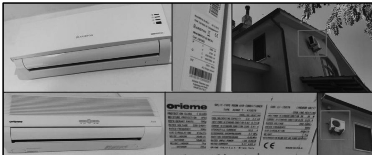
Split e pompe di calore nel sub. 3
