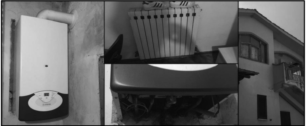
Caldaia in ripostiglio, radiatore e scarico fumi in facciata
