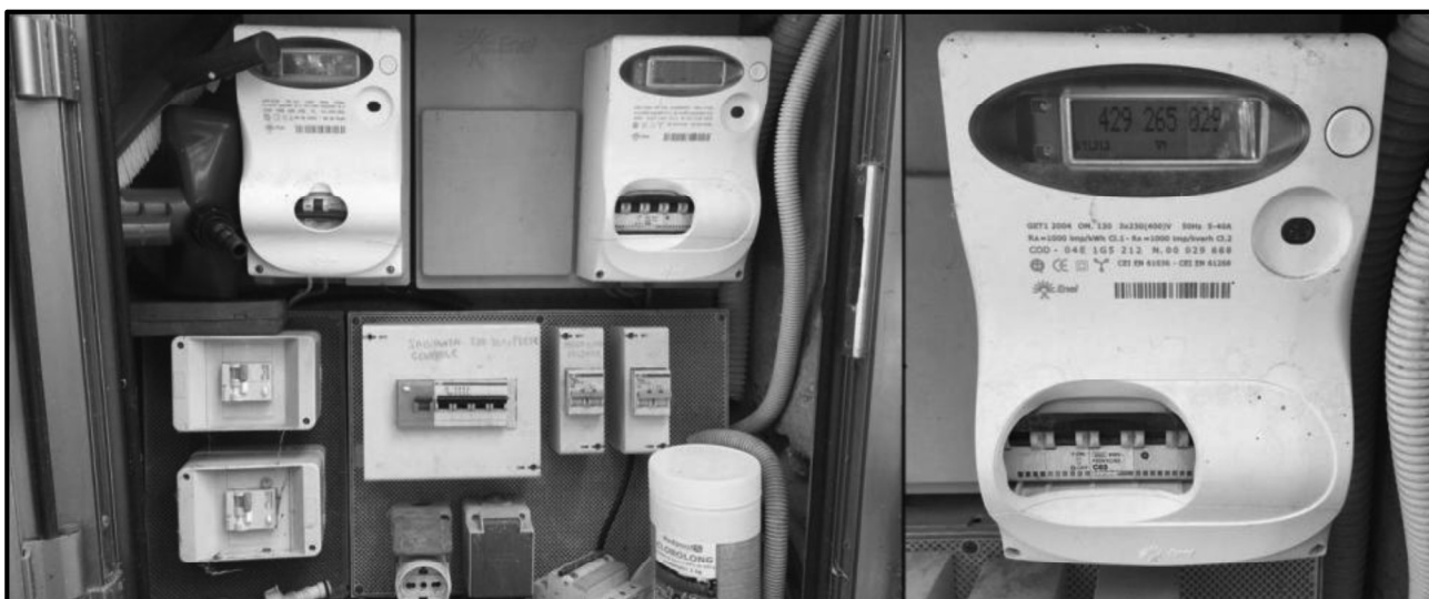
Impianto elettrico: punto di fornitura con contatore
