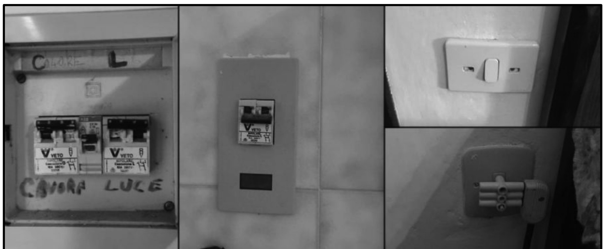
Impianto elettrico: quadri elettrici e dettagli impianto nel sub. 3
