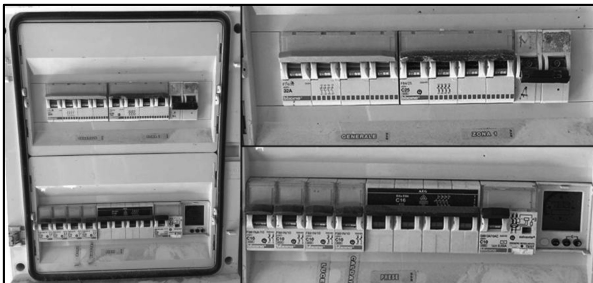
Impianto elettrico: quadro elettrico principale nella p.lla 313
