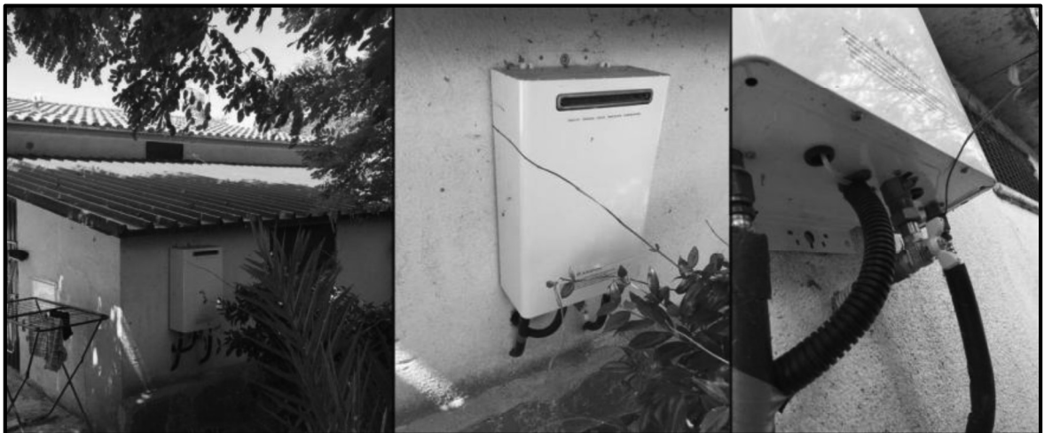
Caldaia per ACS nella p.lla 313
