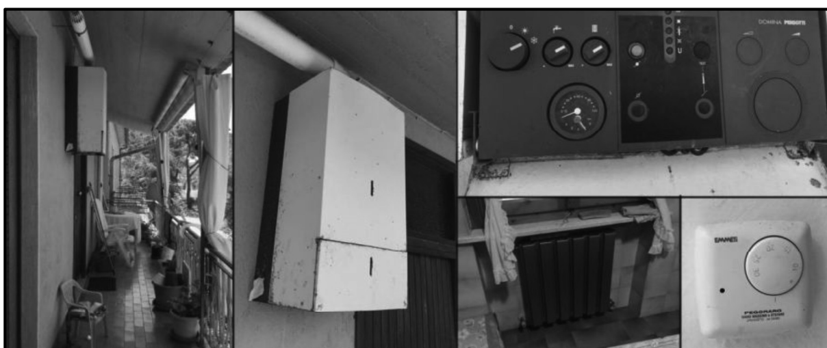
Caldaia, radiatori e termostato nel sub. 3
