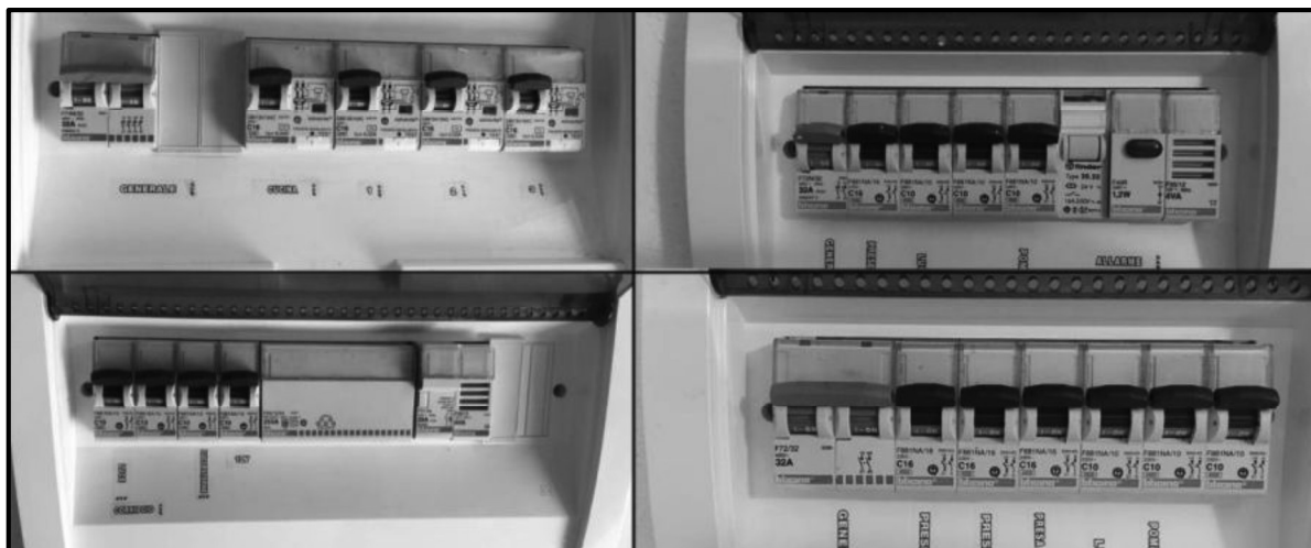
Impianto elettrico: quadri elettrici nella struttura ricettiva
