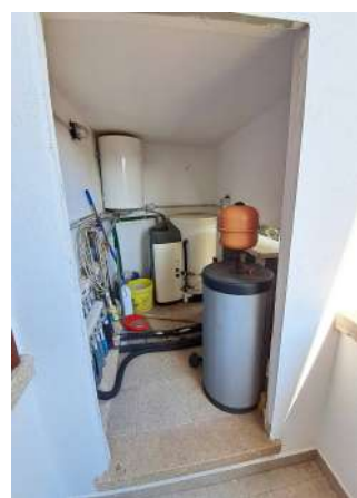
24. Vano tecnico - riscaldamento e accumulo acqua.
