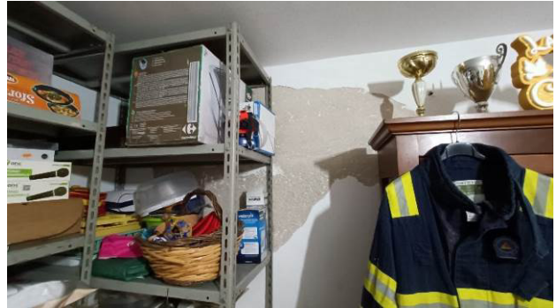
Umidità pareti e distacco della finitura
