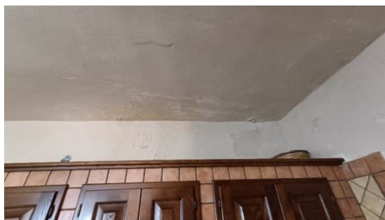
Umidità soffitto e pareti contro terra
