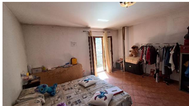
Muffe dovute a condensa superficiale
