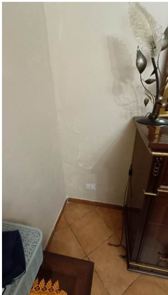
Umidità dovuta verosimilmente a perdita nella doccia retrostante
