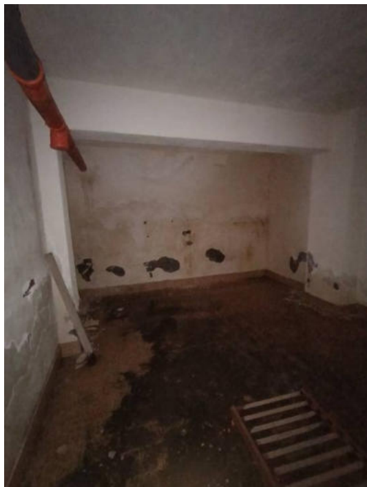
FOTO 9: Dettaglio parete contro terra di fondo, con forte presenza di umidità.
