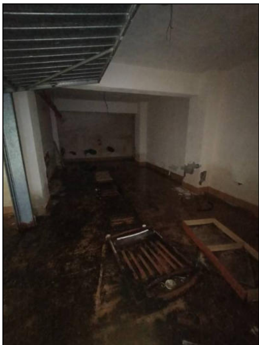
FOTO 7: Interno garage sub. 18, con danni derivanti da umidità di risalita.
