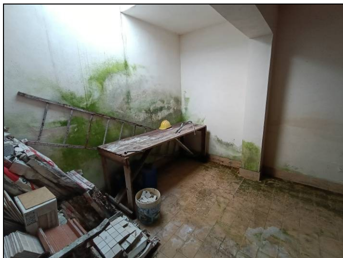
FOTO 9: Dettaglio parete contro terra di fondo, con affiorazione di muffe dovute all'umidità.
