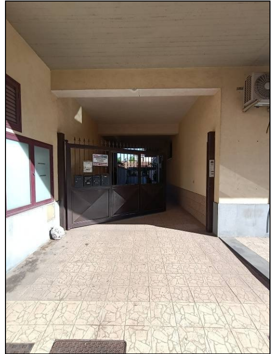
FOTO 2: Cannello automatico per accesso rampa di discesa al piano sottostrada.
