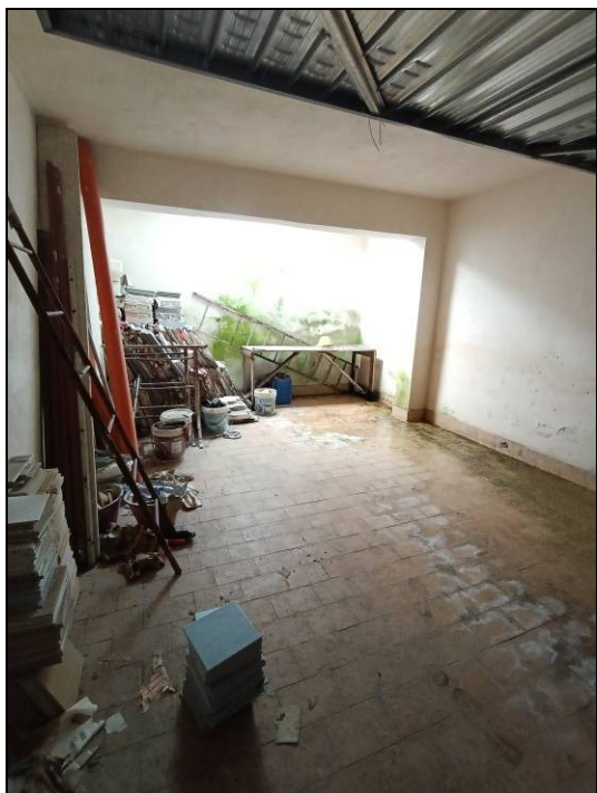
FOTO 7: Interno garage sub. 17, con danni derivanti da umidità di risalita.
