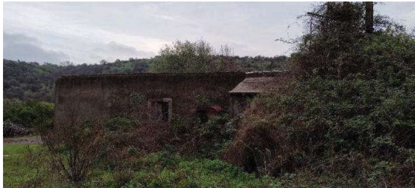
Foto 67 locale tecnico plla 237
