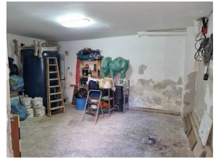
Foto n. 40 P.T. - Locale Box.
