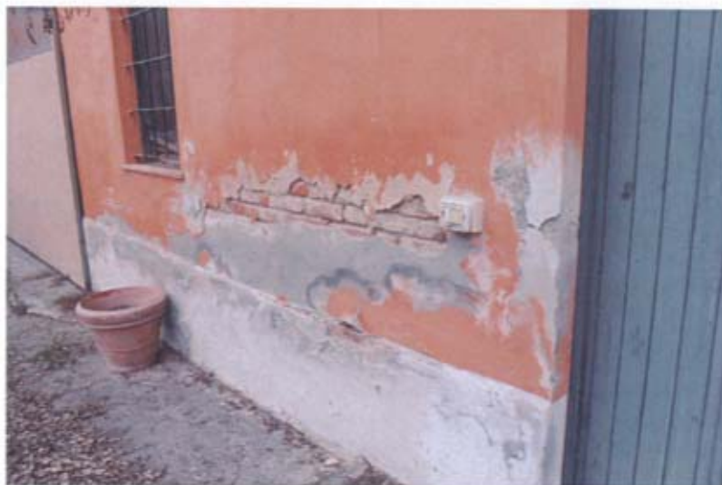
Foto 50: Part. muratura perimetrale ammalorata
