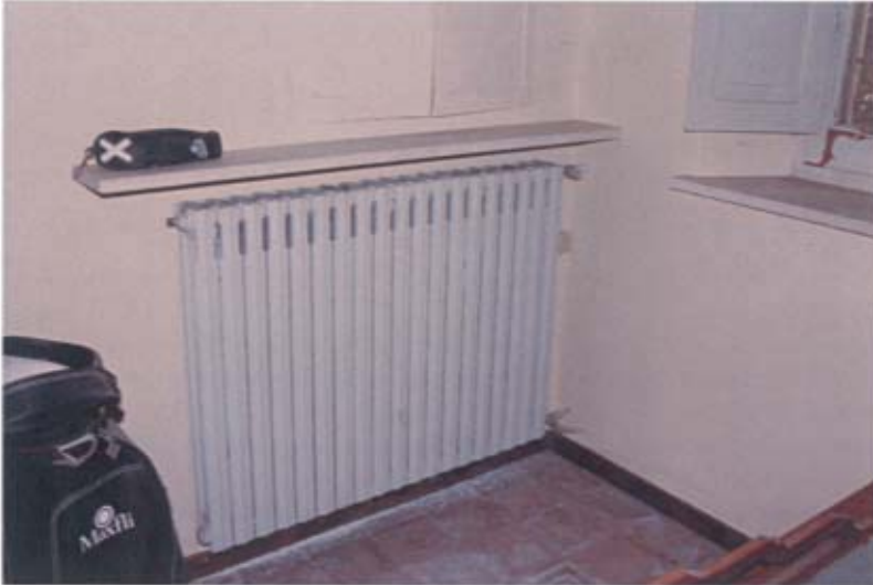
Foto 12: Part. impianto riscaldamento
