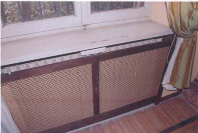
Foto 14: Part. impianto riscaldamento soggiorno
