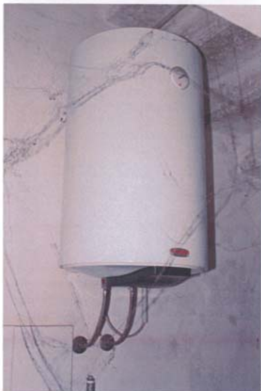
Foto 29: Part. boiler sottoscala cucina
