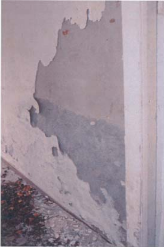
Foto 27: Part. muri interni ammalorati
