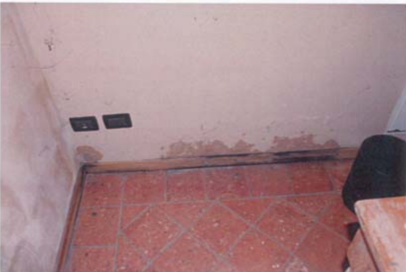
Foto 59: Part. intonaci ammalorati
