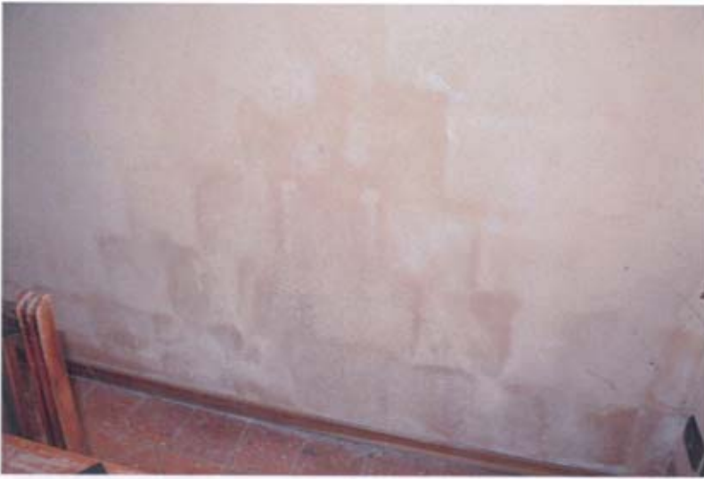
Foto 57: Part. intonaci interni ammalorati
