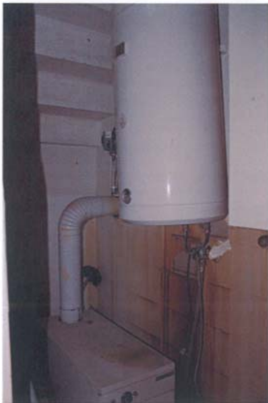
Foto 17: Part. caldaia e boiler sottoscala cucina
