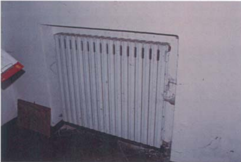
Foto 42: Part. impianto di riscaldamento
