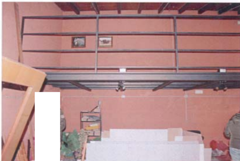
Foto 71: Deposito 1 – Soppalco da regolarizzare
