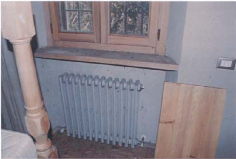
Foto 99: Part. impianto di riscaldamento
