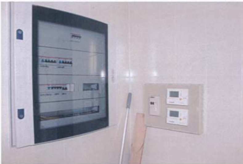
Foto 94: Part. quadro elettrico di zona
