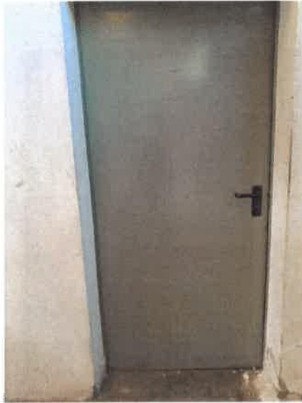
Foto 22 porta accesso spogliatoio 2
