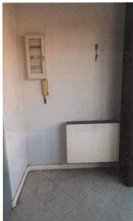
Foto 36 impianto citofonico e ventilconvettore
