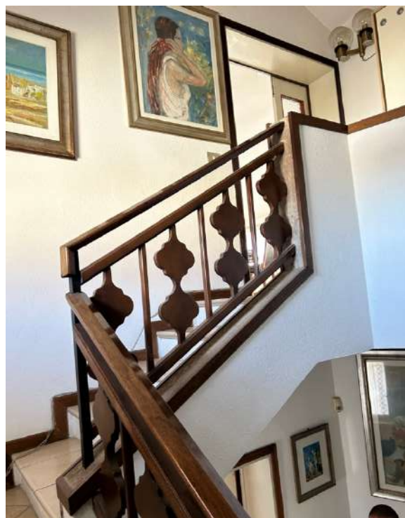
Foto 13 e 14: vano scala di collegamento tra P1 e P2. Si notano infiltrazioni di acqua dal tetto
