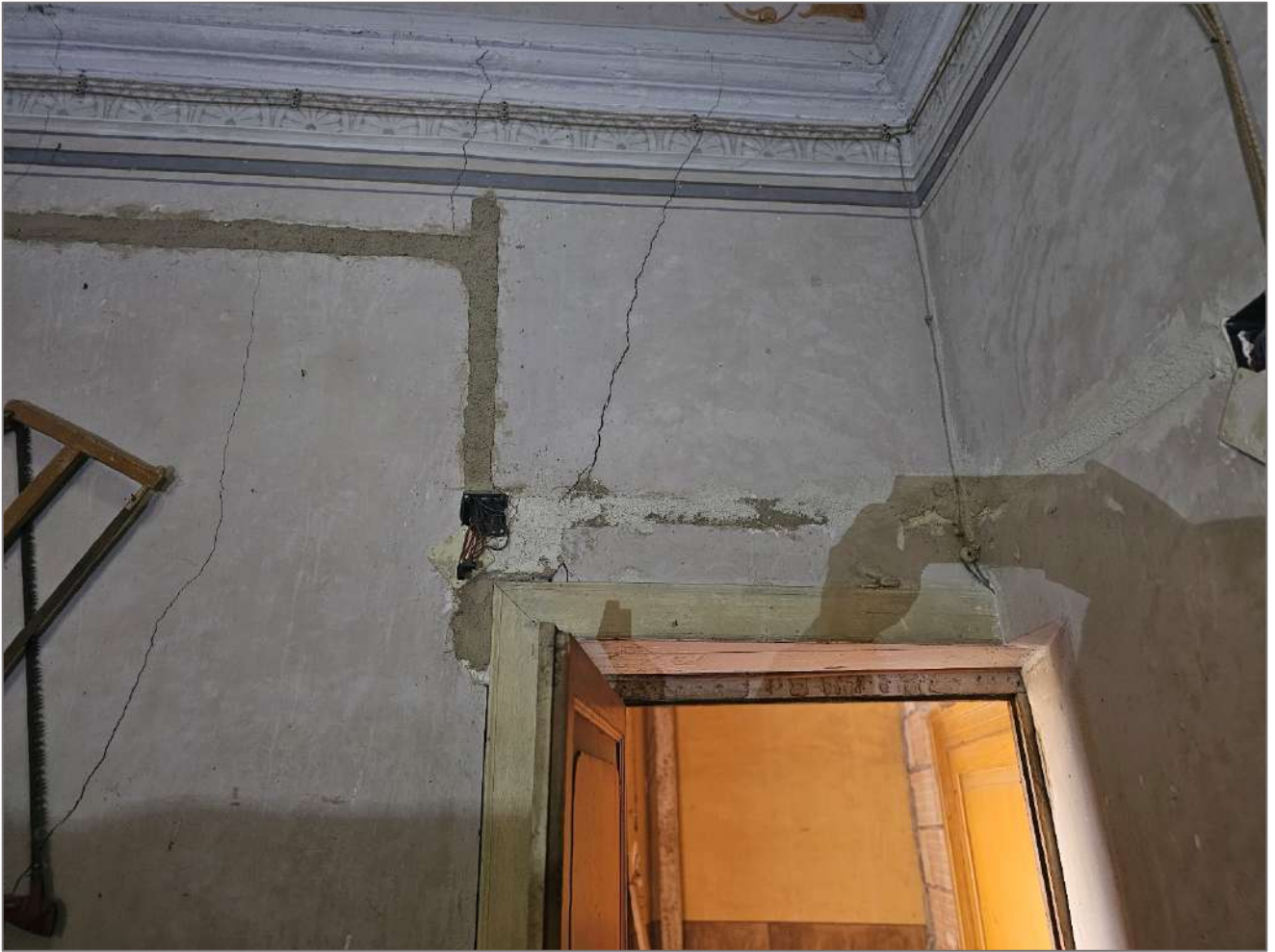
Foto 40, 41 – Quadro fessurativo all'interno del sub 25
