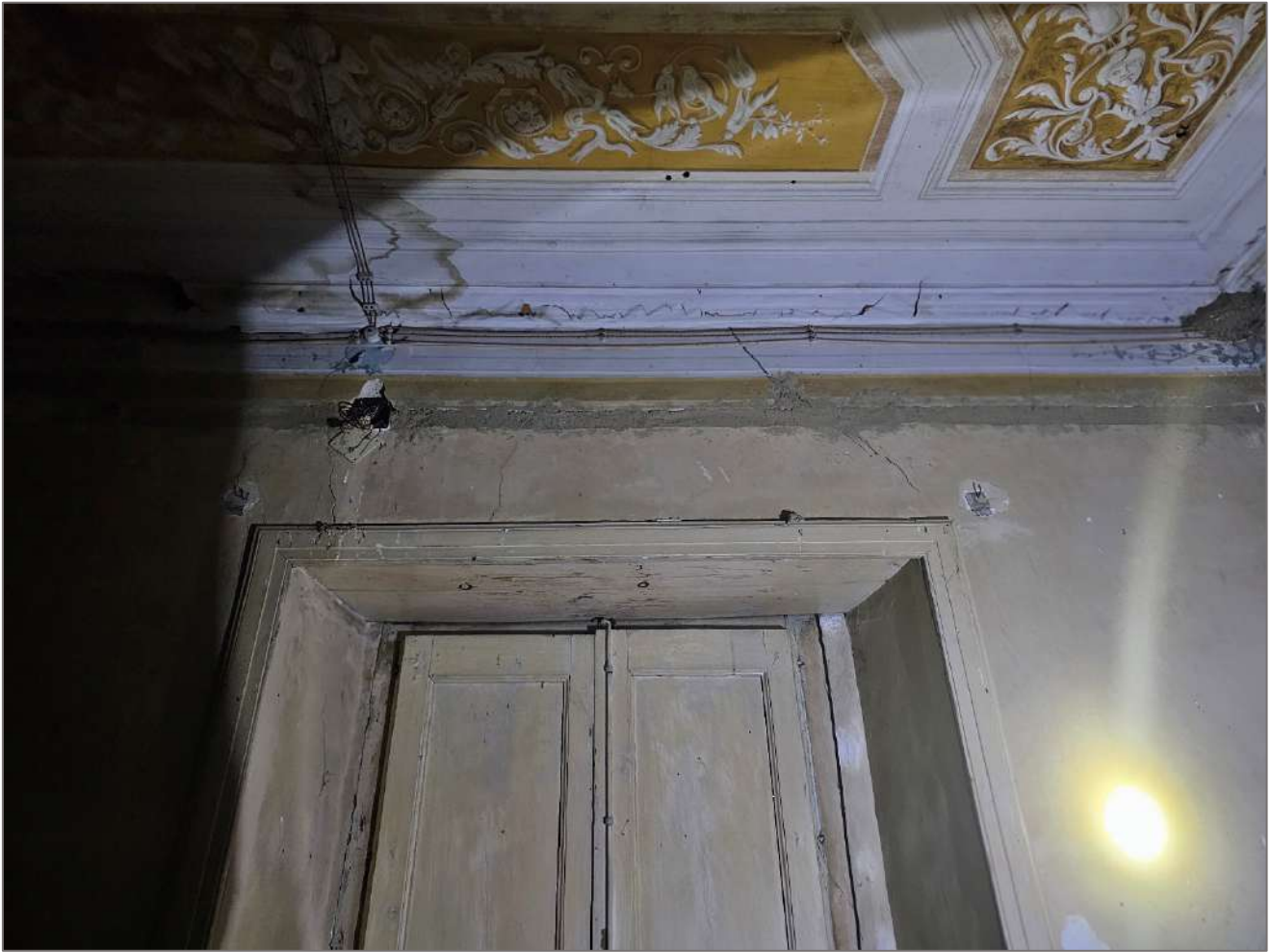
Foto 46, 47 – Quadro fessurativo all'interno del sub 25
