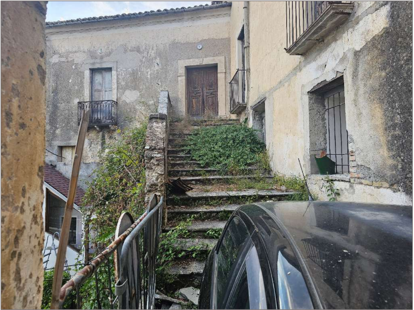
Foto 34, 35 – Condizioni di dissesto del parapetto e della scala esterna dalla quale si accede al sub 25
