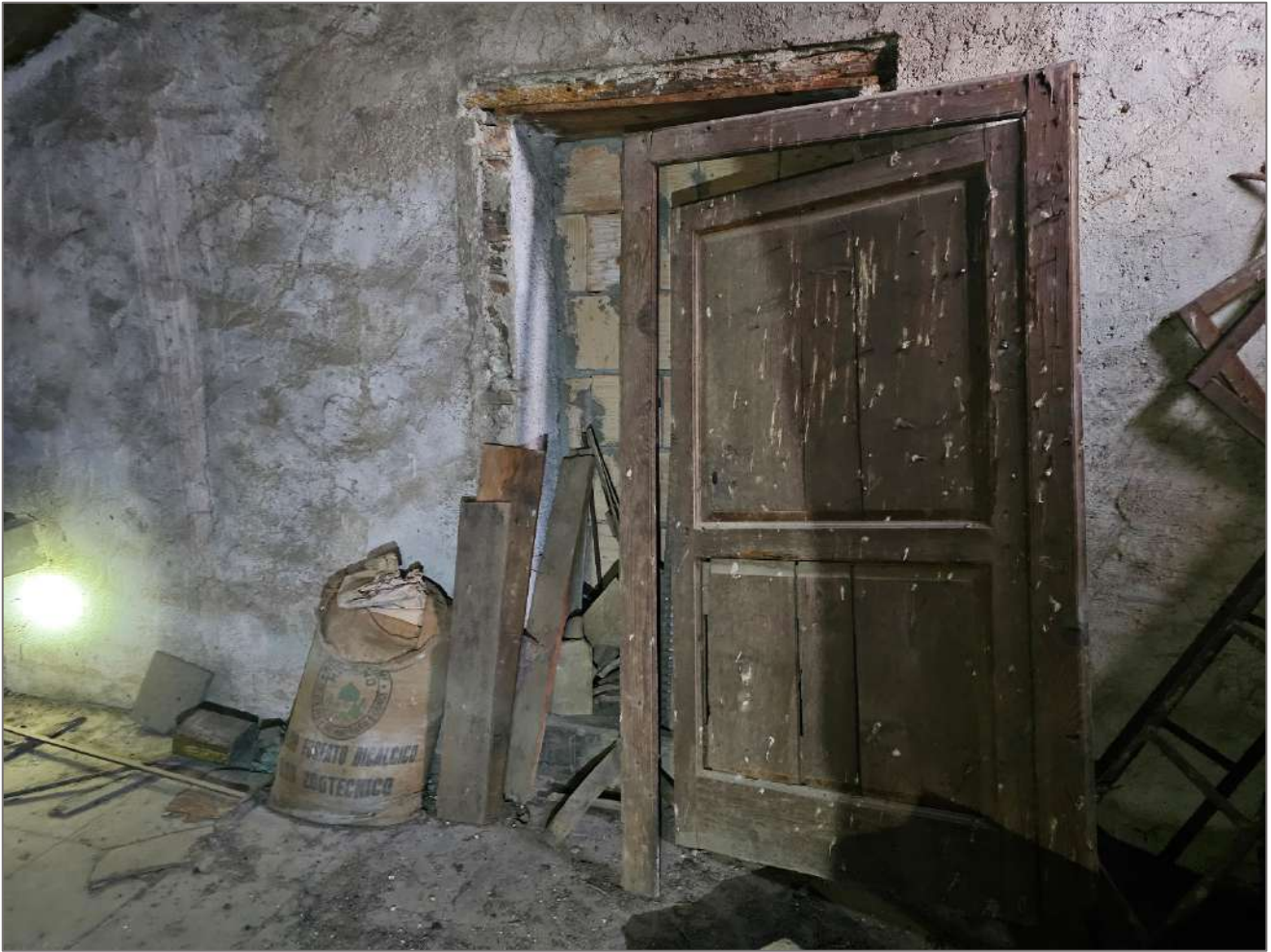
Foto 53, 54– Particolare porta murata nel sottotetto di un'altra unità immobiliare confinante che consentiva l'accesso al sub 25
