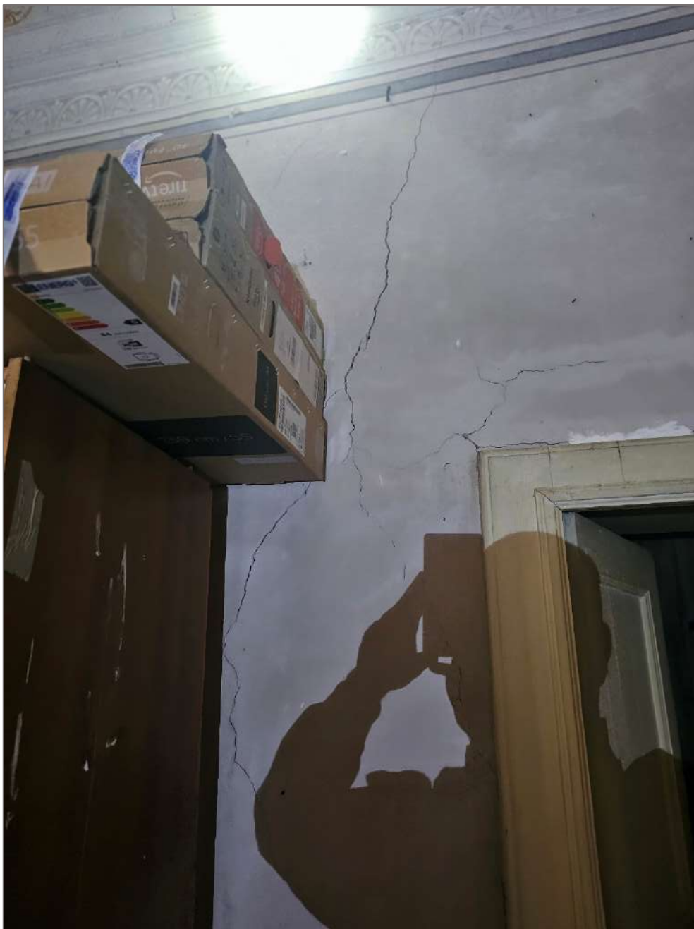
Foto 44, 45 – Quadro fessurativo all'interno del sub 25
