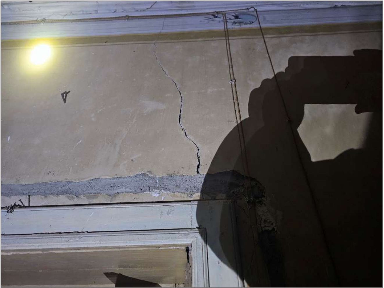
Foto 50, 51– Quadro fessurativo all'interno del sub 25 e scala di accesso al sottotetto di un'altra unità immobiliare confinante
