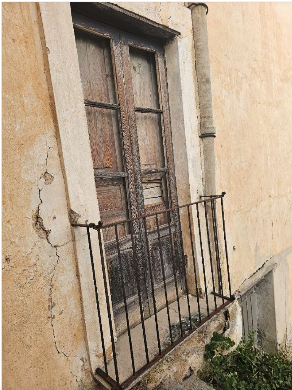
Foto 36, 37 – Particolare stato di degrado della facciata, dove sono presenti due canne fumarie in eternit e dei balconi
