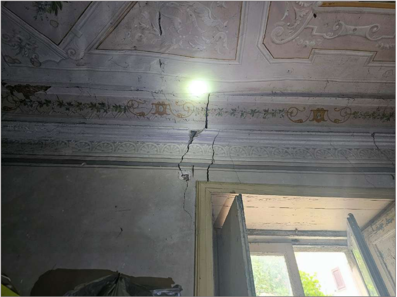
Foto 38, 39 – Quadro fessurativo all'interno del sub 25
