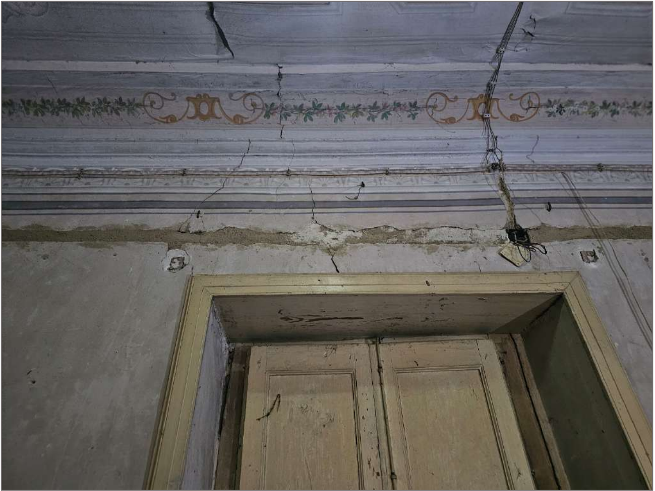
Foto 42, 43 – Quadro fessurativo all'interno del sub 25
