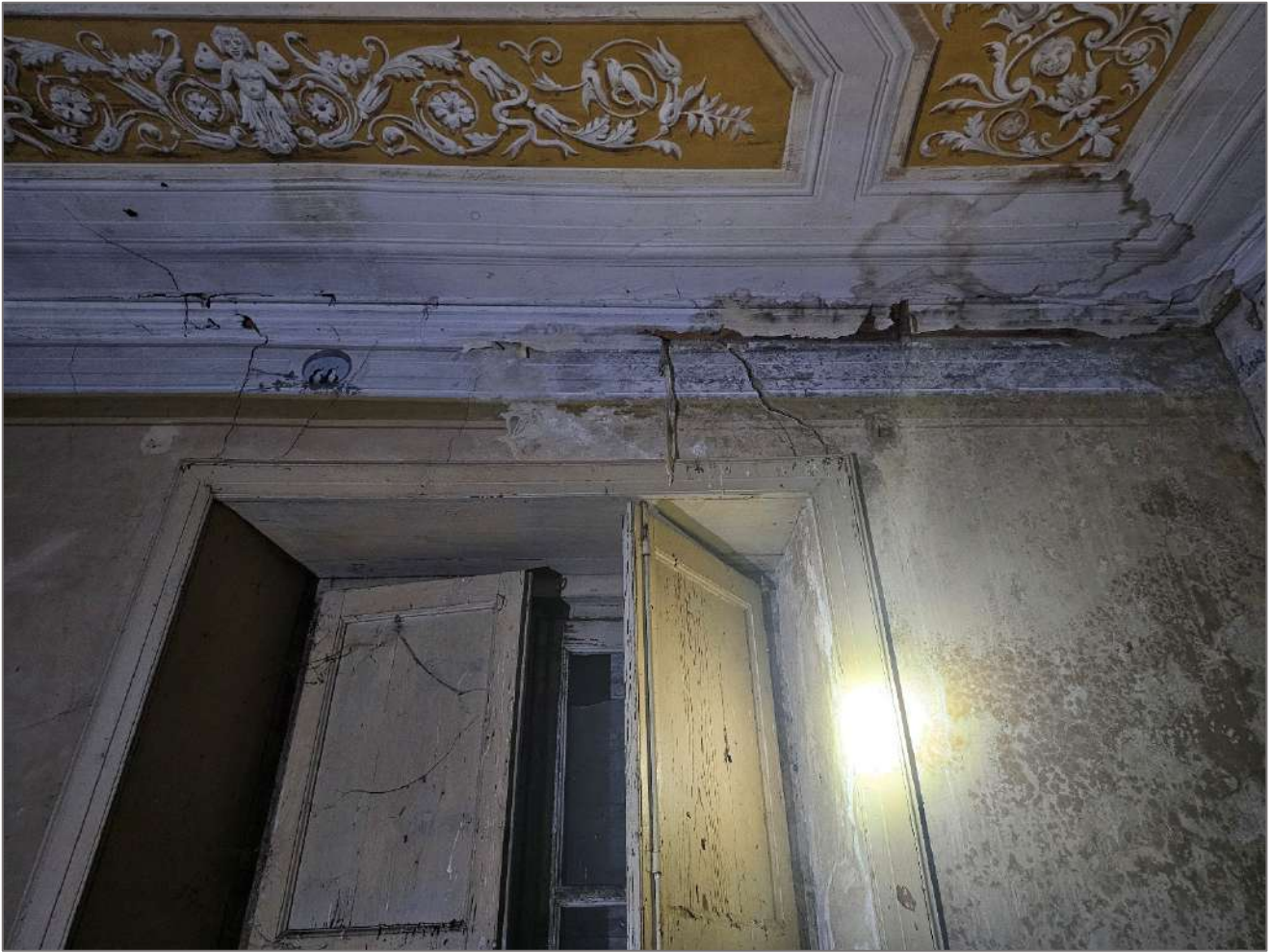
Foto 48, 49 – Quadro fessurativo all'interno del sub 25
