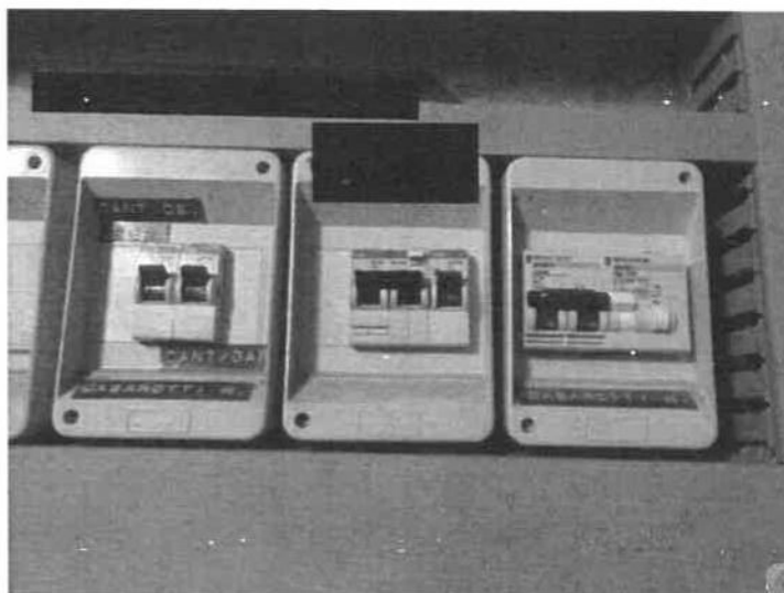
FOTO 2 SALVAVITA CANTINA+BOX E CANTINA 505
