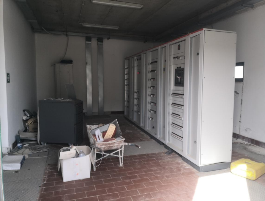
Foto n. 1 – Locale tecnico n. 1 - impianto elettrico - CORPO A – P.T.
