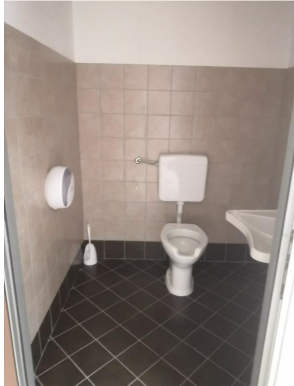
Foto n. 41 – w.c. H - CORPO A – P.1°
