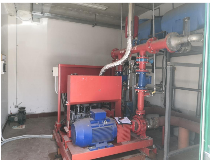
Foto n. 4 – Locale tecnico n. 4 - impianto idrico - CORPO A – P.T.
