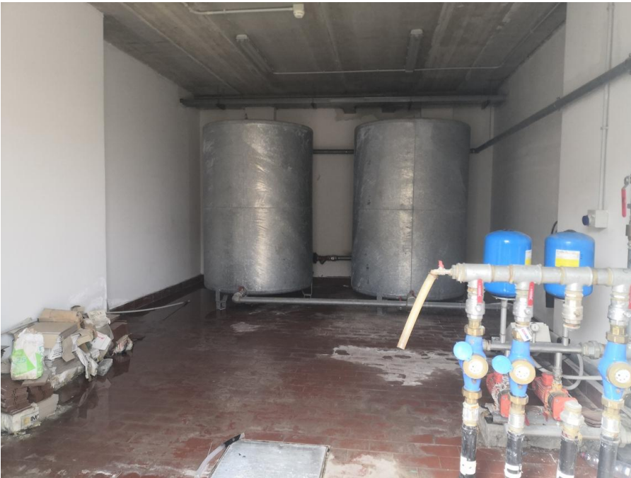
Foto n. 2 – Locale tecnico n. 2 - impianto idrico - CORPO A – P.T.
