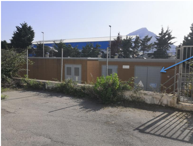
Foto n. 1 – cabina elettrica - SUB 3
