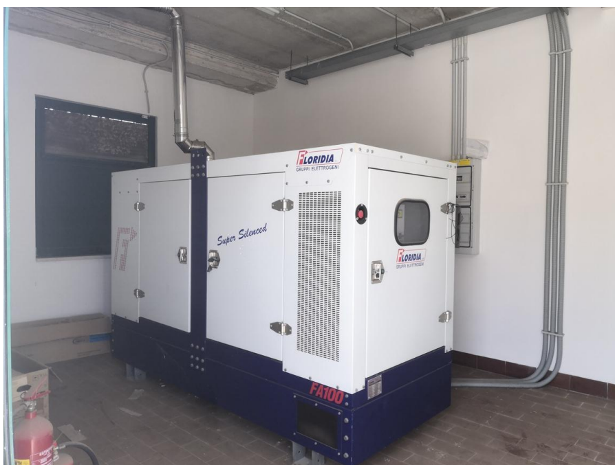
Foto n. 3 – Locale tecnico n. 3 – gruppo continuità - CORPO A – P.T.
