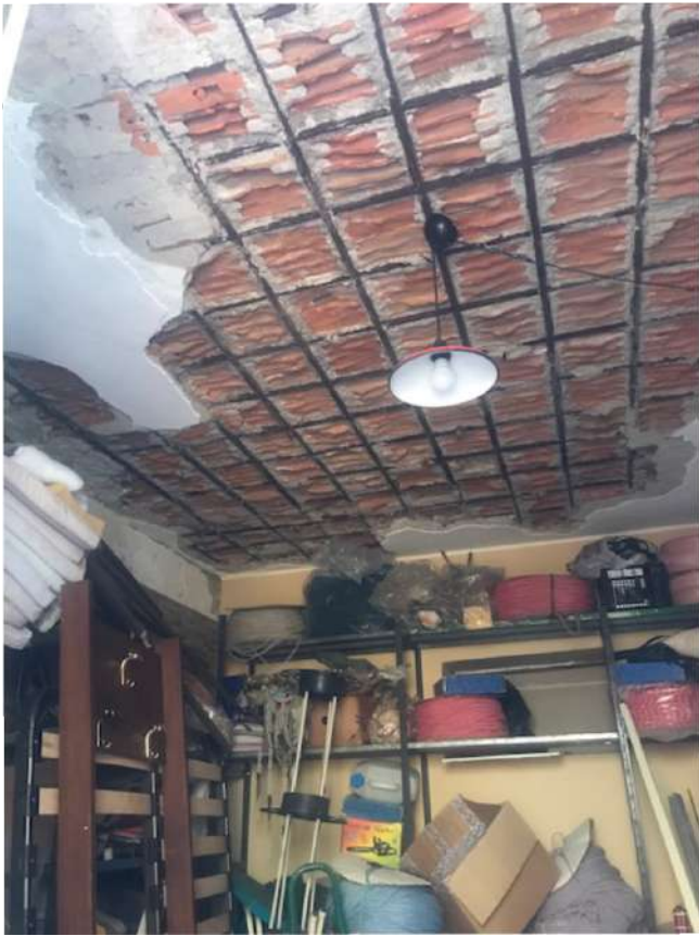
Foto 11 : le attuali condizioni del solaio della camera “B”, coi ferri e le pignatte a vista , che hanno spinto il debitore sig. ad interdire la stanza.
