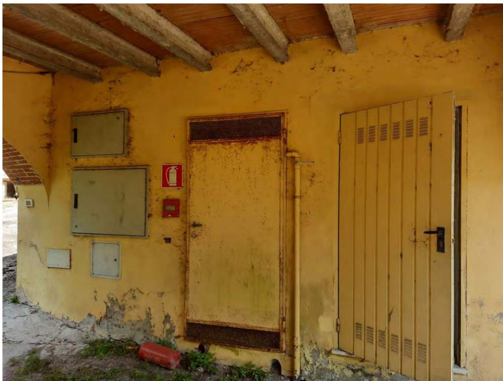
FOTO 26 – Accesso alla centrale termica a comune
