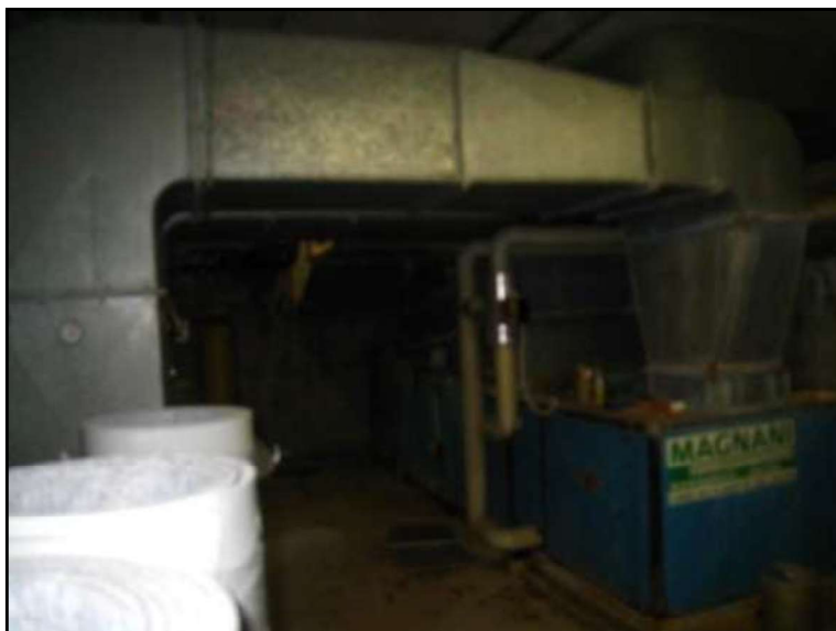
FOTO 83 PIANO INTERRATO ALTRA VISTA VANO CALDAIA DELLA FOTO PRECEDENTE.
