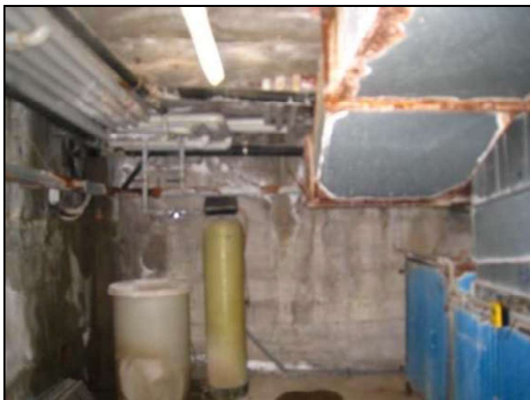
FOTO 86 PIANO INTERRATO ALTRA VISTA VANO CALDAIA DELLA FOTO PRECEDENTE.
