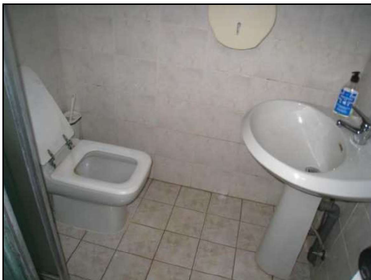
FOTO 43 PIANO TERRA VISTA W.C. ZONA SPOGLIATOI DELLA FOTO PRECEDENTE.
