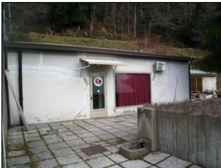
FOTO 1 VISTA RIPRESA SUL LATO SUD VERSO LA PORZIONE DESTINATA A PALESTRA E SERVIZI.
