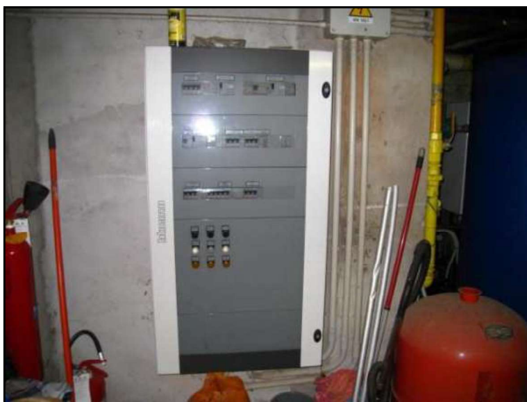
FOTO 78 PIANO INTERRATO ALTRA VISTA RIPRESA NEL VANO CALDAIA DELLA FOTO PRECEDENTE.
