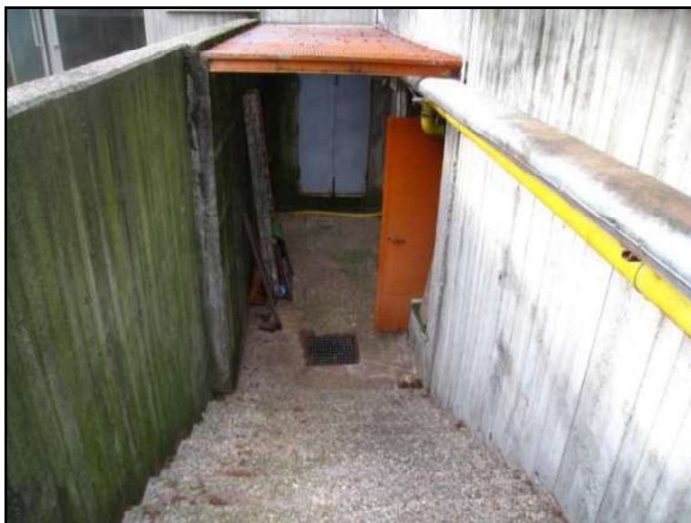
FOTO 76 PIANO TERRA VISTA RAMPA SCALA DI COLLEGAMENTO AI VANI CALDAIA.
