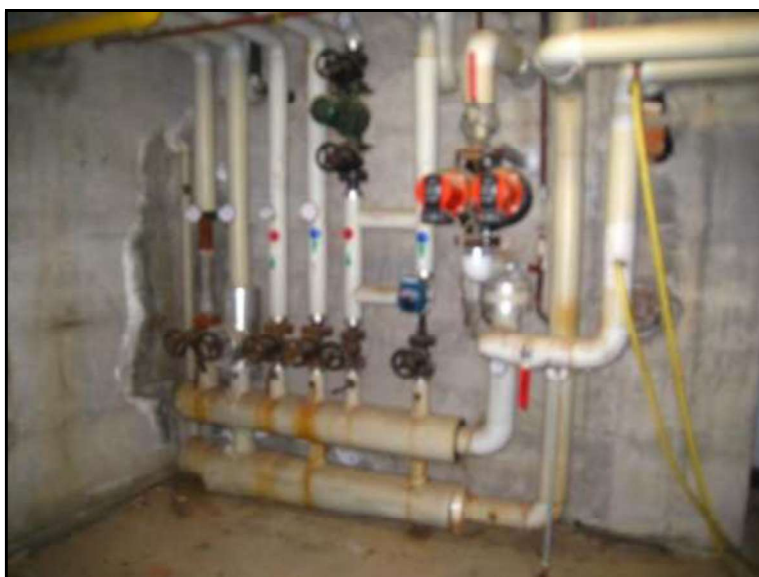
FOTO 84 PIANO INTERRATO ALTRA VISTA VANO CALDAIA DELLA FOTO PRECEDENTE.
