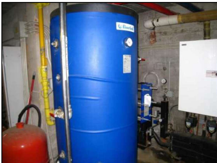
FOTO 80 PIANO INTERRATO ALTRA VISTA RIPRESA NEL VANO CALDAIA DELLA FOTO PRECEDENTE.
