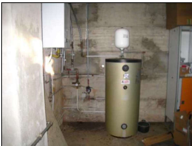
FOTO 21 ALTRA VISTA DEL MAGAZZINO DELLA FOTO PRECEDENTE. OVE È PRESENTE CALDAIA.
