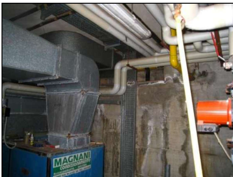
FOTO 87 PIANO INTERRATO ALTRA VISTA VANO CALDAIA DELLA FOTO PRECEDENTE.
