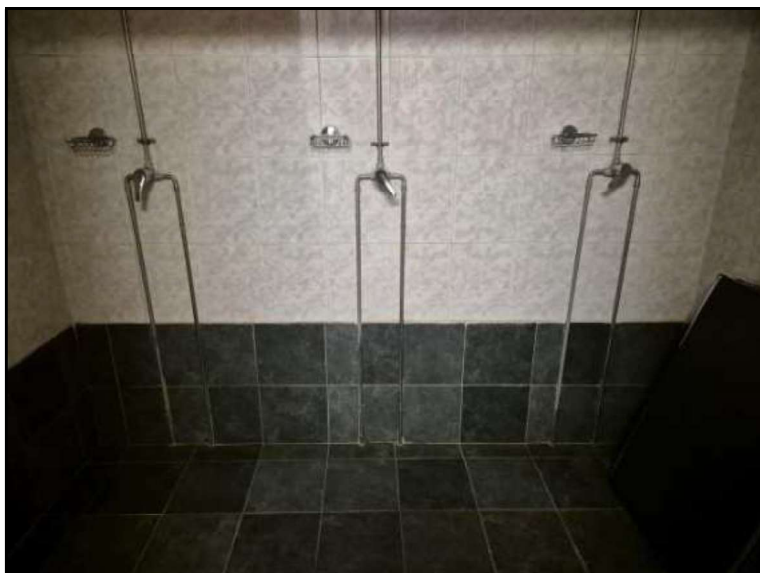
FOTO 17 VISTA DOCCE AL SERVIZIO DELLO SPOGLIATOIO DELLA FOTO PRECEDENTE.
