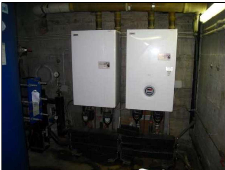
FOTO 79 PIANO INTERRATO ALTRA VISTA RIPRESA NEL VANO CALDAIA DELLA FOTO PRECEDENTE.
