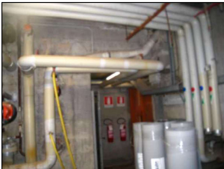
FOTO 85 PIANO INTERRATO ALTRA VISTA VANO CALDAIA DELLA FOTO PRECEDENTE.
