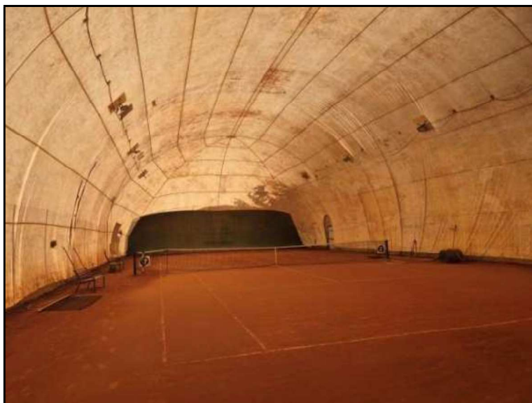
FOTO 16 VISTA INTERNA CAMPO DA TENNIS CON COPERTURA PRESSOSTATICA NON AUTORIZZATA E DA RIMUOVERE.
