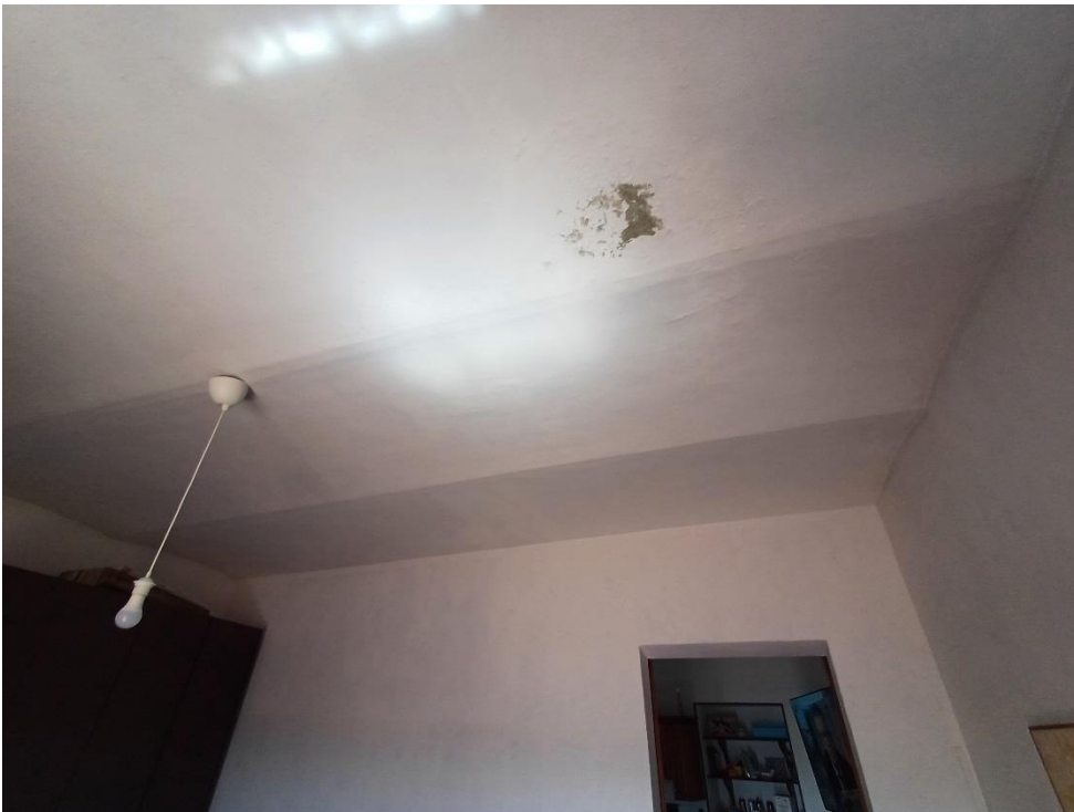
Foto 45 – Infiltrazioni sul soffitto
