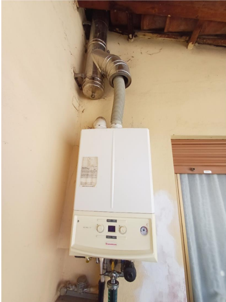
Foto 46 – Caldaia sul terrazzo
