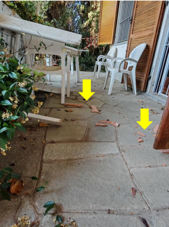
Fotografia scattata in data 28/06/2025: presenza di porzioni di laterizio distaccatesi dall'intradosso del solaio.
