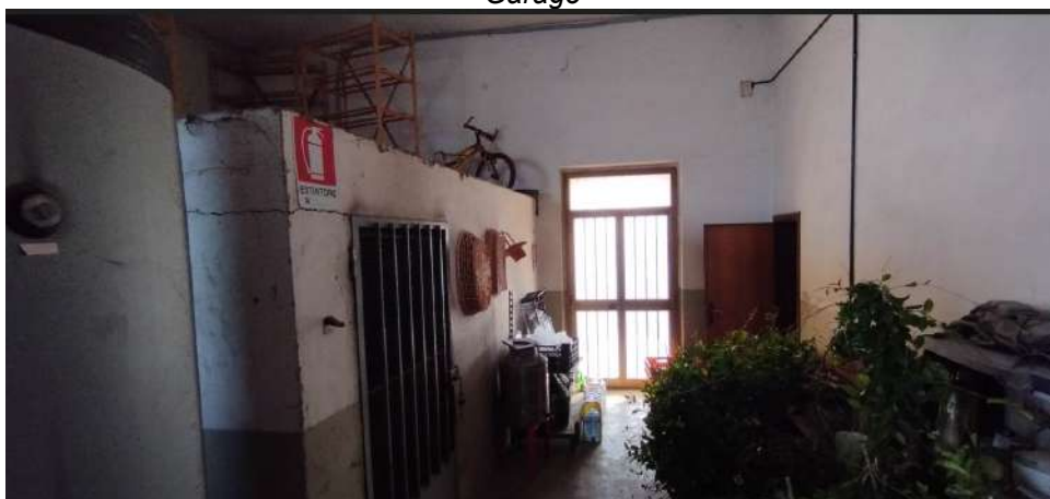
Ingresso centrale termica
