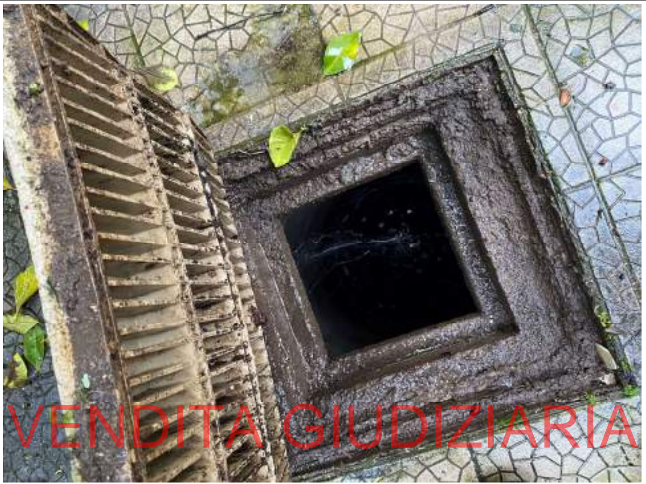
Foto 12: POZZO NERO IN COMUNIONE CON IL SUB. 3 (APPARTAMENTO)
