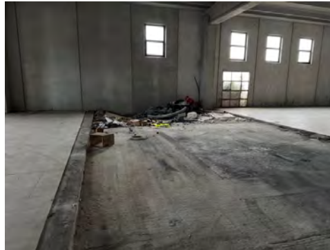
Foto n. 14 Vano n. 1 – Pavimento assente
