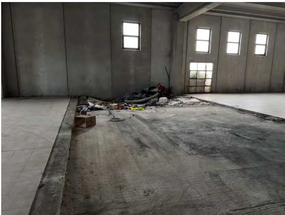
Foto n. 14 Piano terra – Vano 1 – Pavimento e massetto da rifare
