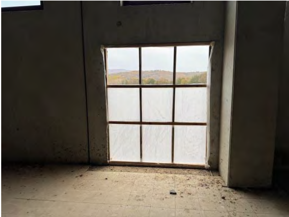
Foto n. 17 Piano terra – Vano 2 – Infisso assente
