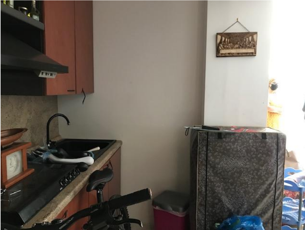
FOTO 7) PARETE DELLA PARTE ACCORPATA ABUSIVAMENTE
