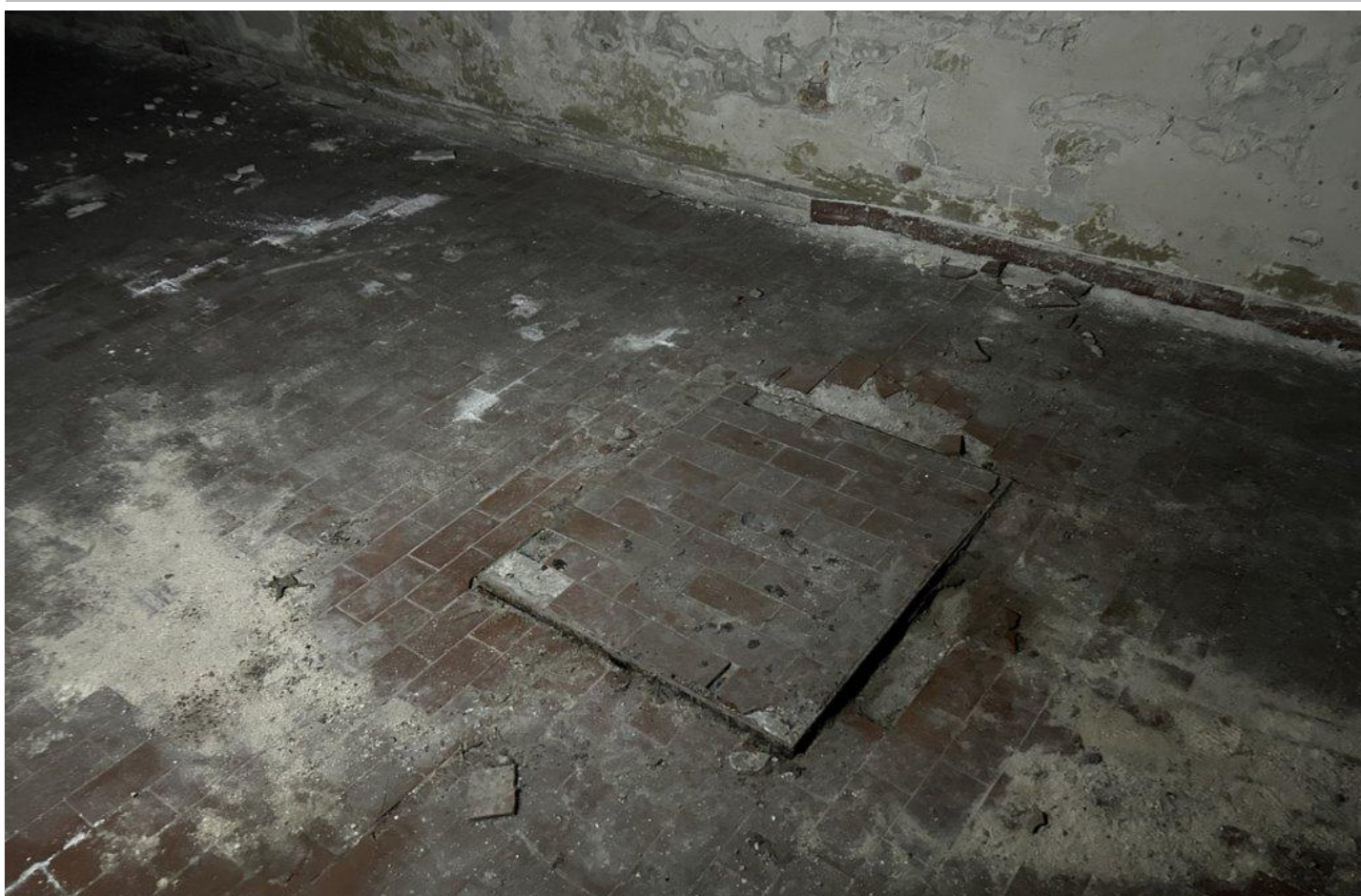
Sub. 25 - interno garage piano seminterrato - probabili rigurgiti di acque bianche/nere
