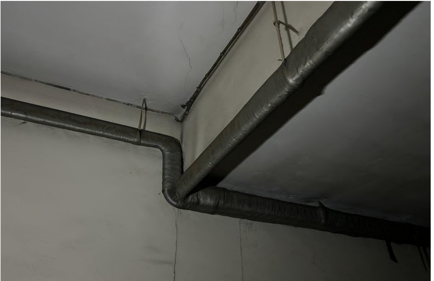
Sub. 25 - interno garage piano seminterrato - attraversamento impianti condominiali
