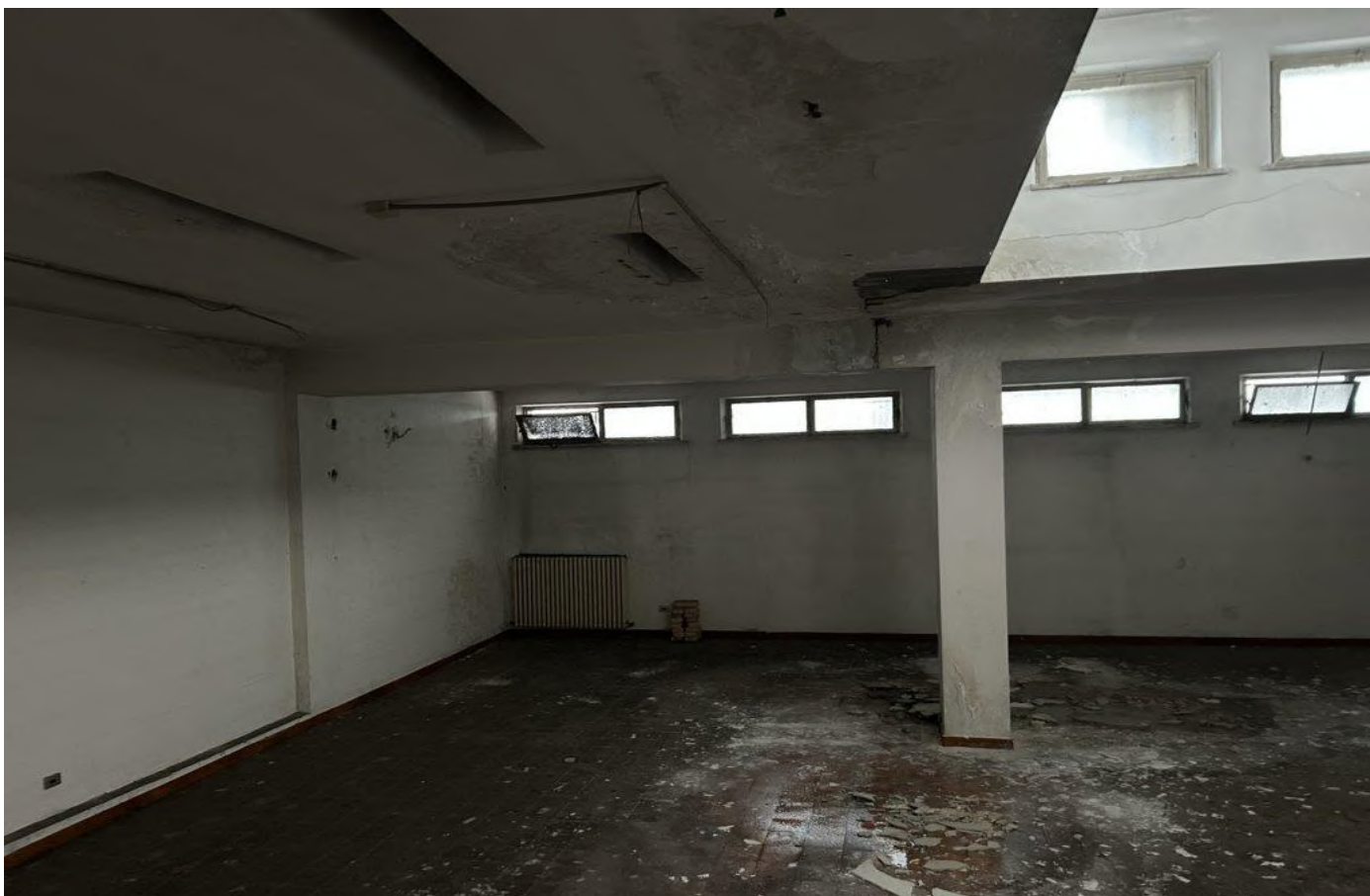
Sub. 27 -interno magazzino piano terra - fenomeni infiltrativi e sfondamenti solaio
