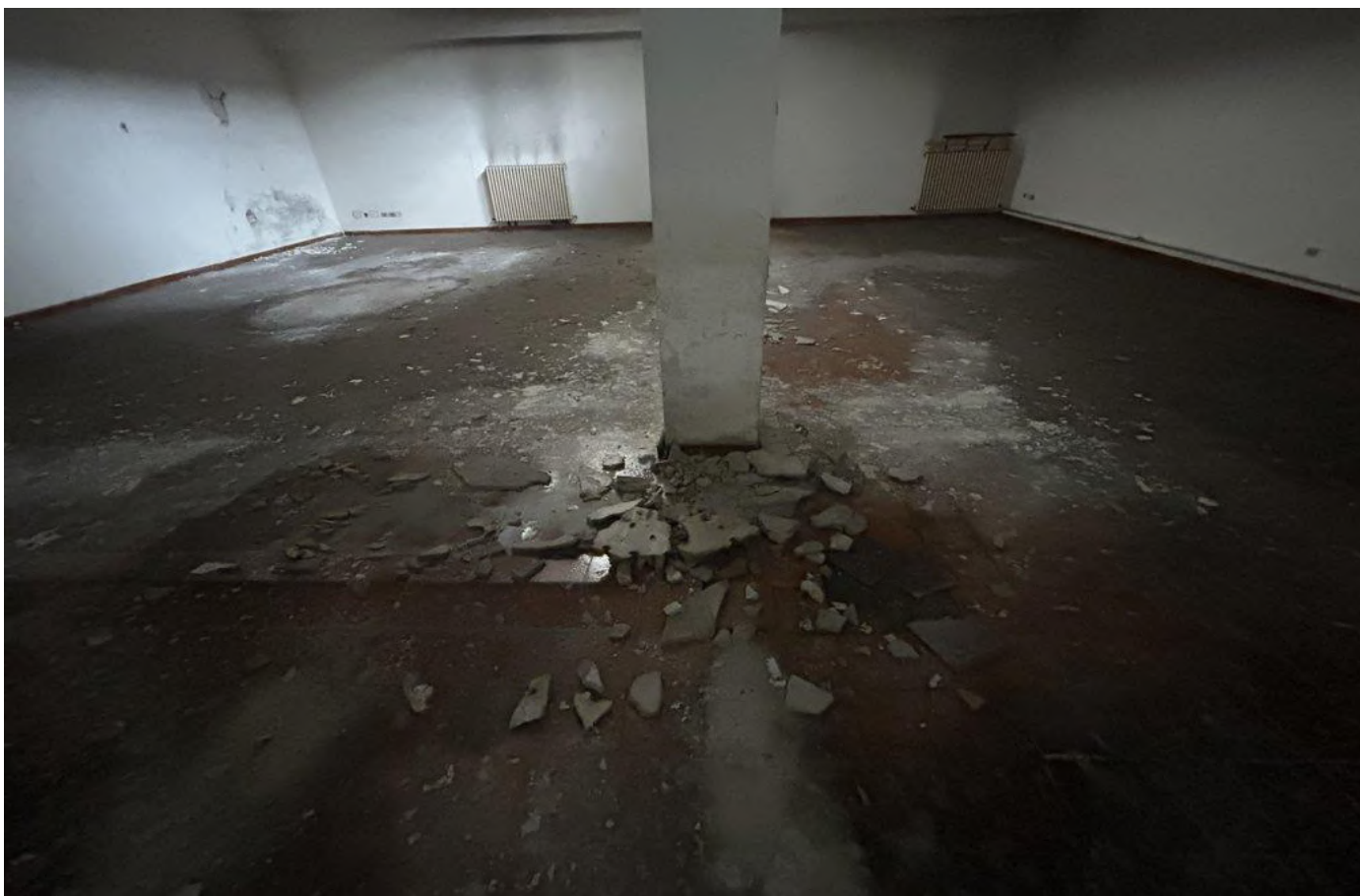
Sub. 27 -interno magazzino piano terra - particolare sfondellamenti
