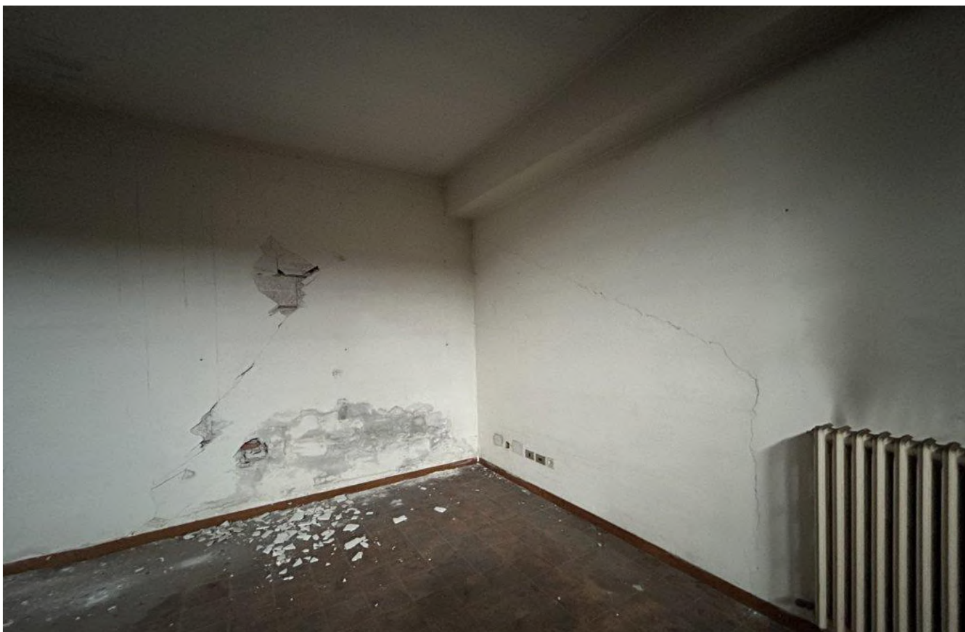
Sub. 27 -interno magazzino piano terra - particolare lesioni pareti
