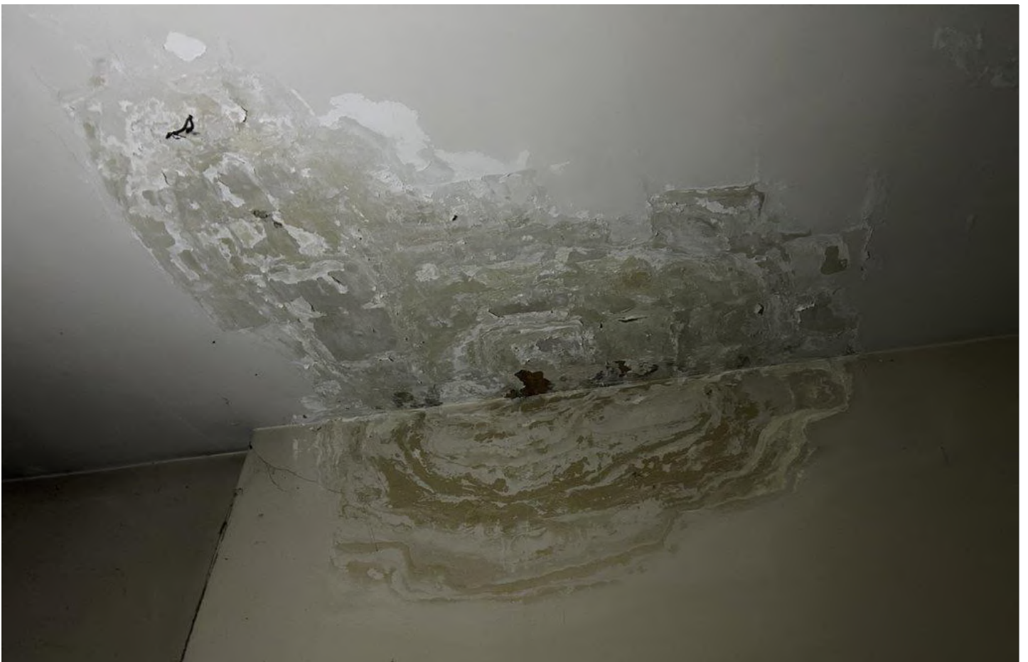
Sub. 25 - interno garage piano seminterrato - particolare infiltrazioni
