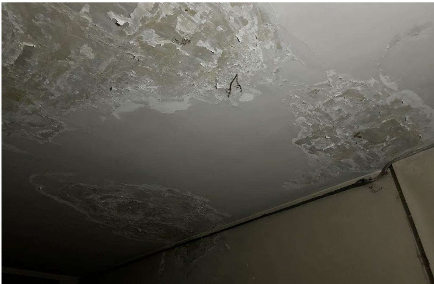
Sub. 25 - interno garage piano seminterrato - particolare infiltrazioni
