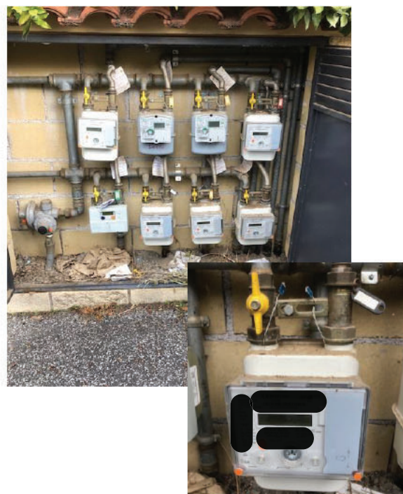
Figura 20_ Vista Contatore GAS
