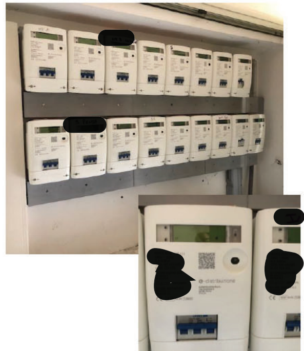
Figura 16_Vista Contatore Elettricità
