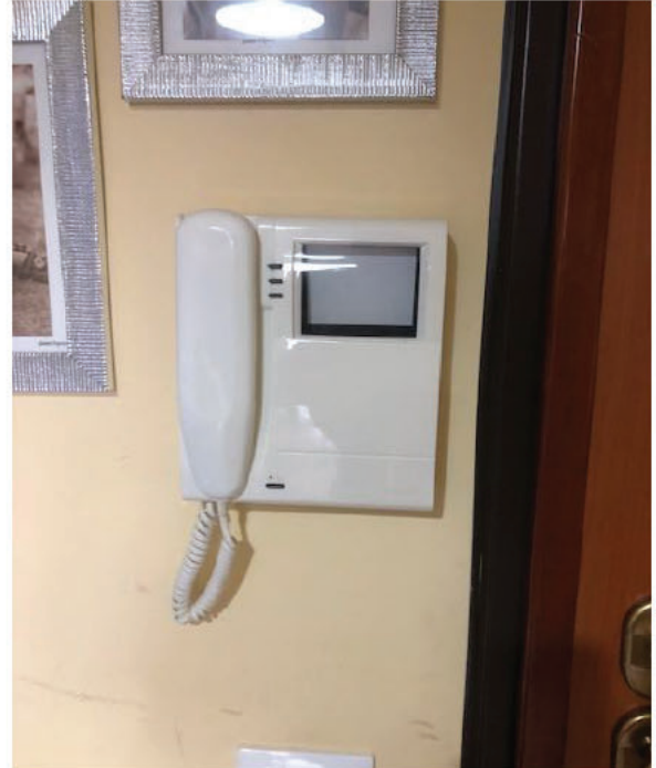
Figura 14_Vista impianto citofonico interno
