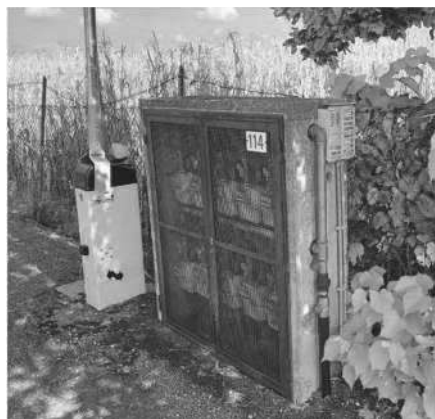
Figura 11: nicchia contatori situata all'inizio dello stradello
